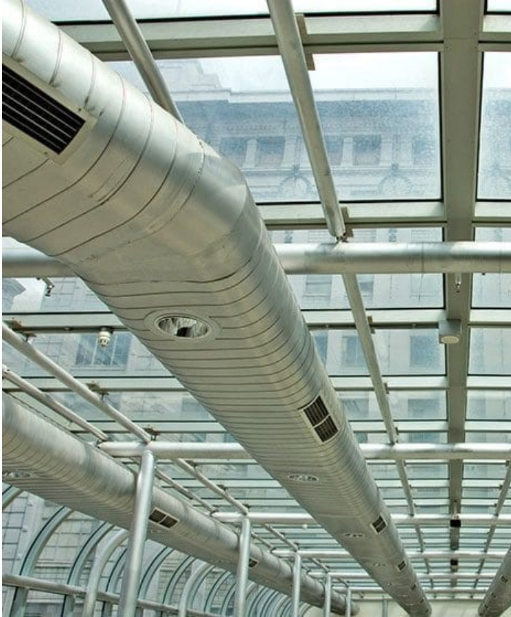
Kuva 7. Soikea ilmastointikanava. (HAS-Vent 2023.)
