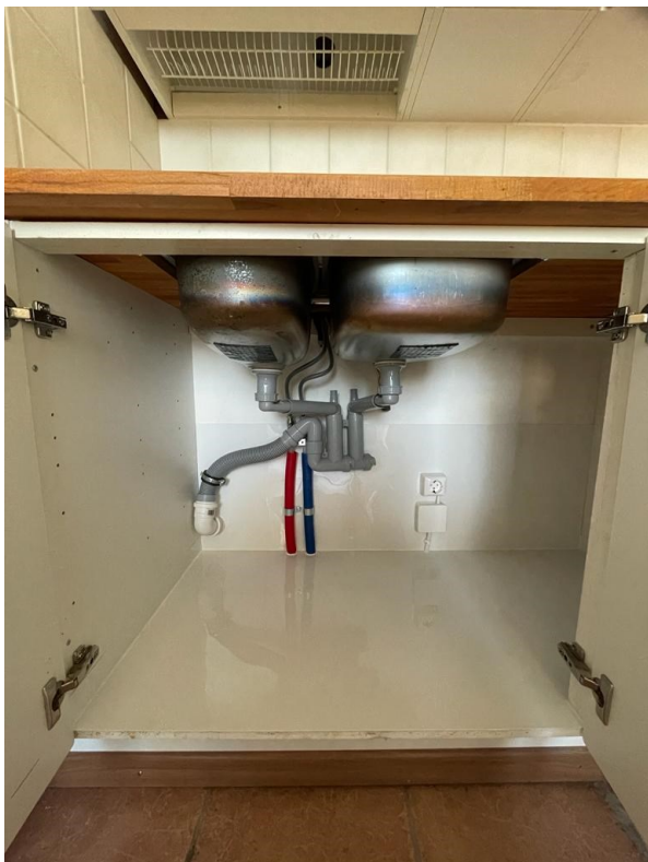
Kuva 11. Havainto tiskipöydän alle asennetusta vuotovesikaukalosta.
