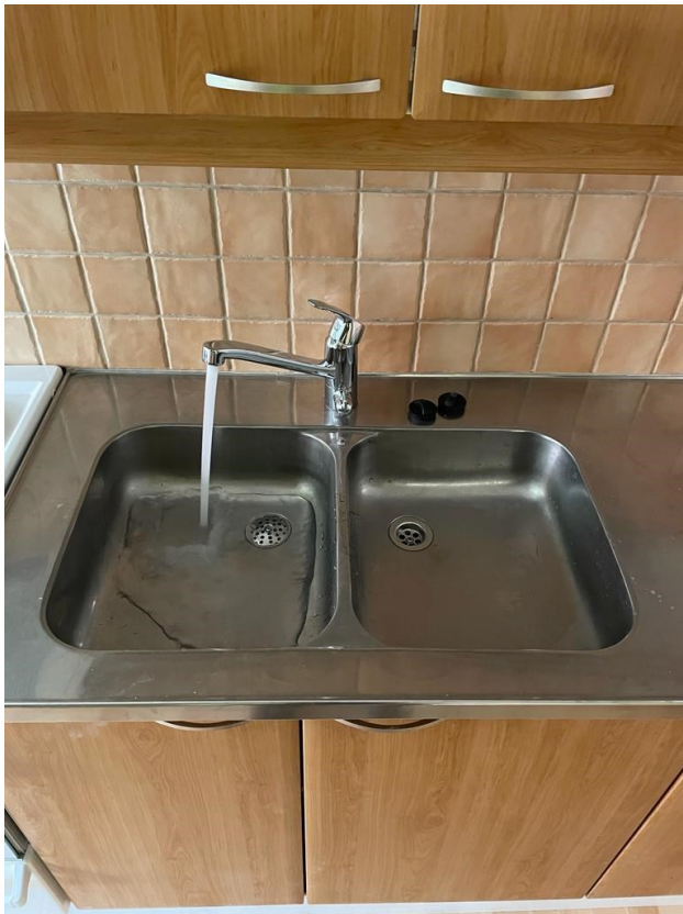
Kuva 10. Havainto kohteen allashanan juoksuputken rajoituksesta.
