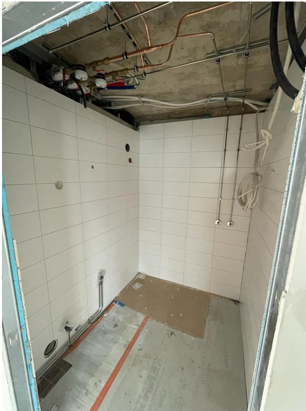
Kuva 13. Havainto tilasta, jossa ei ole tehty ennaltaehkäiseviä toimenpiteitä työnaikaisen vesivahingon varalta.
