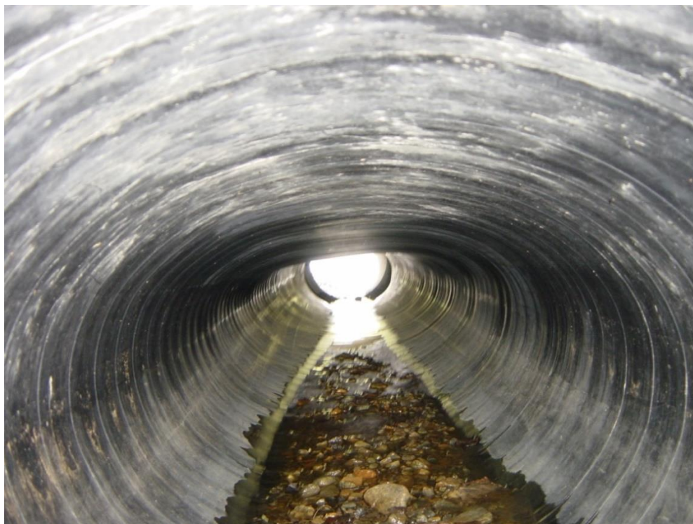
Kuva 5. Lommahtanut muoviputki (S. Petrow, henkilökohtainen tiedonanto 28.2.2014).
