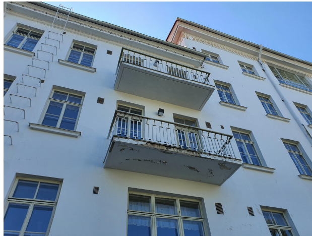
KUVA 41. Parvekkeiden pintakäsittely irtoaa alustastaan.
