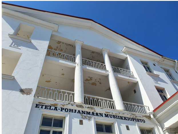
KUVA 40. Päärakennuksen julkisivujen maali irtoaa alustastaan paikoitellen.
