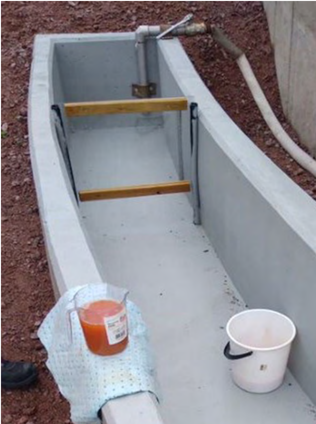
Kuva 3. Ojan alkupäässä oleva patolevy ja virtauksen säätöventtiili (Manu Kettunen 2023).
