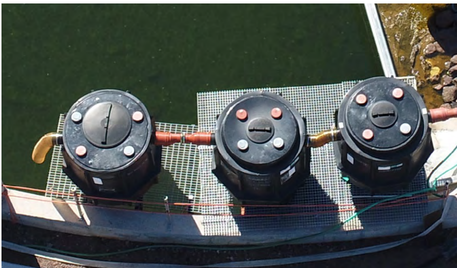
Kuva 4. Öljyntorjunta-altaan öljynerotinlaitteisto muodostuu kahdesta II-luokan ja yhdestä I-luokan öljynerottimista, jotka on kytketty sarjaan (Manu Kettunen 2022).
