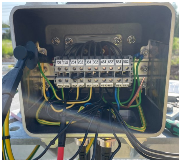
KUVA 23. Mittauskytkentöjä toisioliitinkotelossa (Sjödahl 2023).
