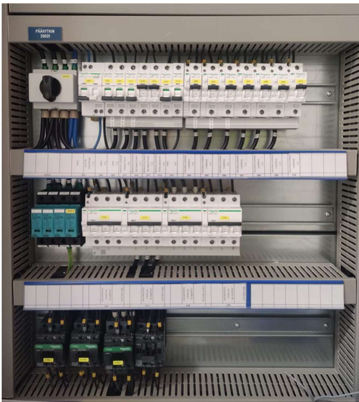
KUVA 17. Savunpoiston pääkytkin, sulakkeet ja kontaktorit
