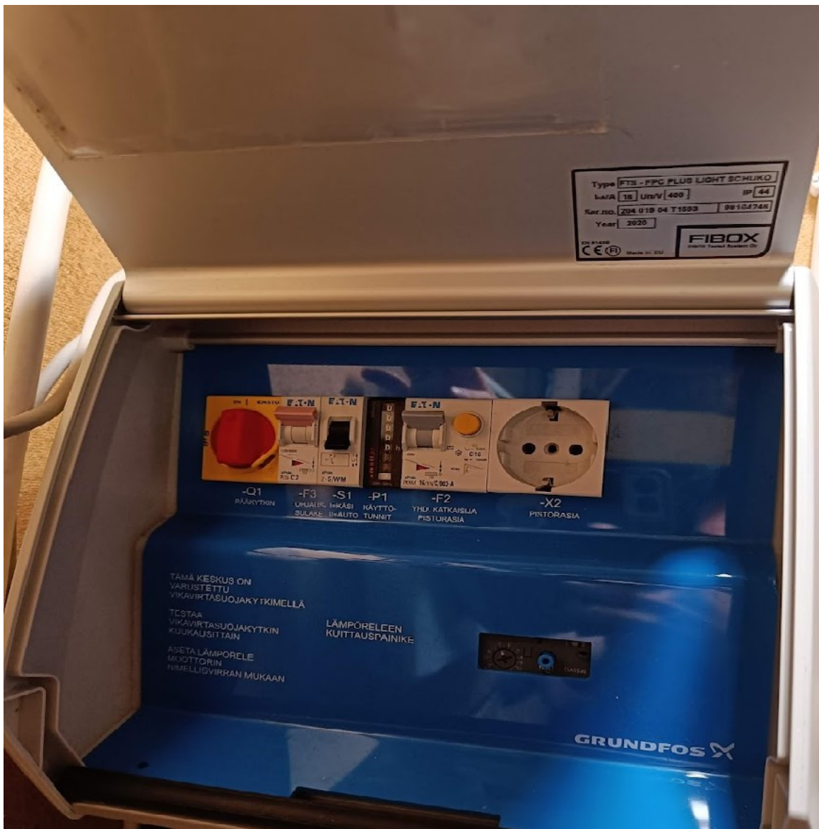
Kuva 13. Työn teettäjän pumppaamokeskus.
