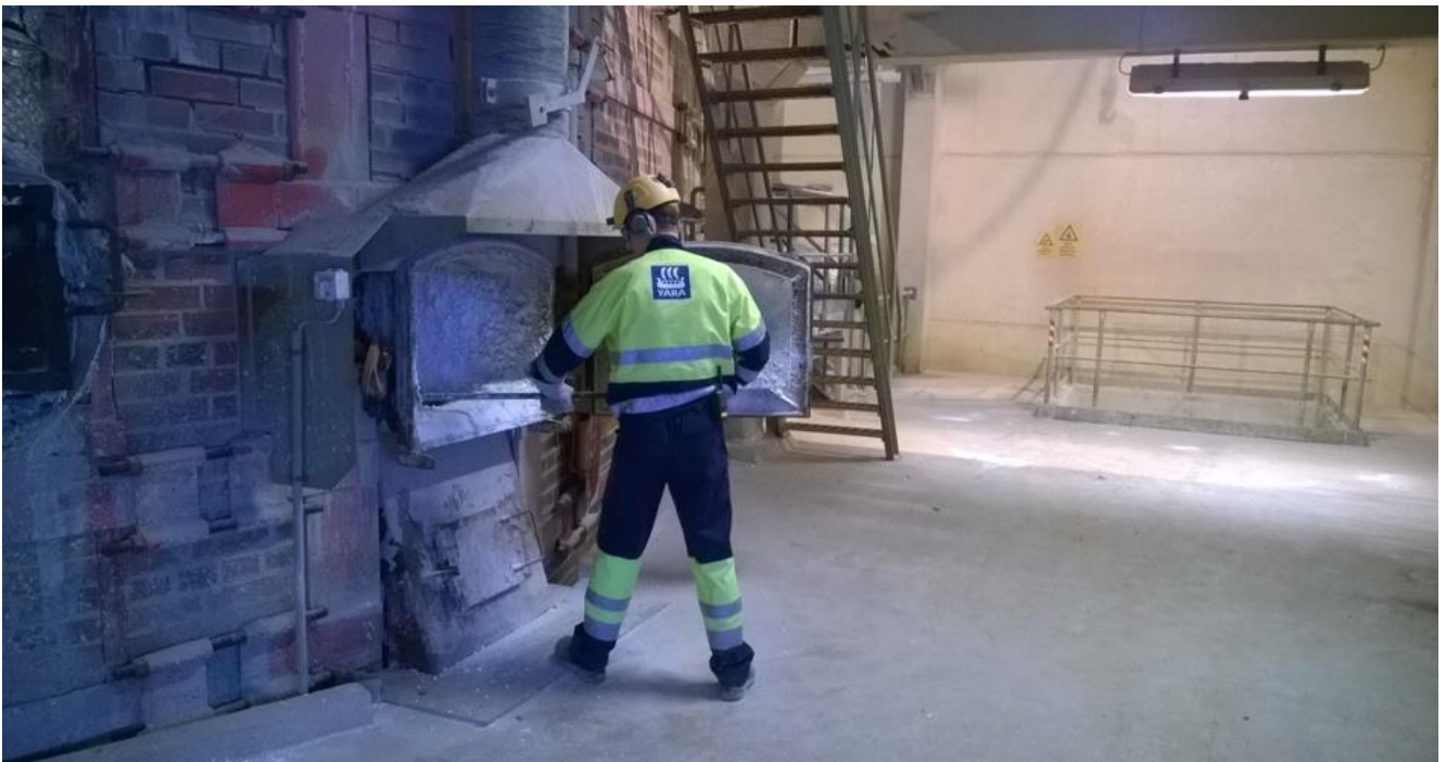
KUVA 2. Uunin hoitoluukku. (Yara Kokkolan tehtaat)
