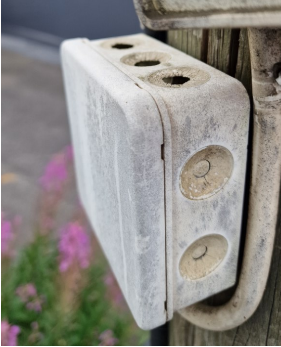
KUVA 3 Jakorasian haurastuneet ja auenneet läpivientireiät
