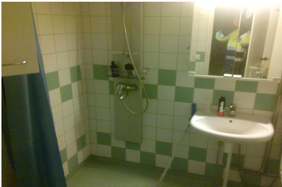
KUVA 4. Kuva korjaustarpeessa olevasta kylpyhuoneesta (Hämäläinen 2012-06-07)
