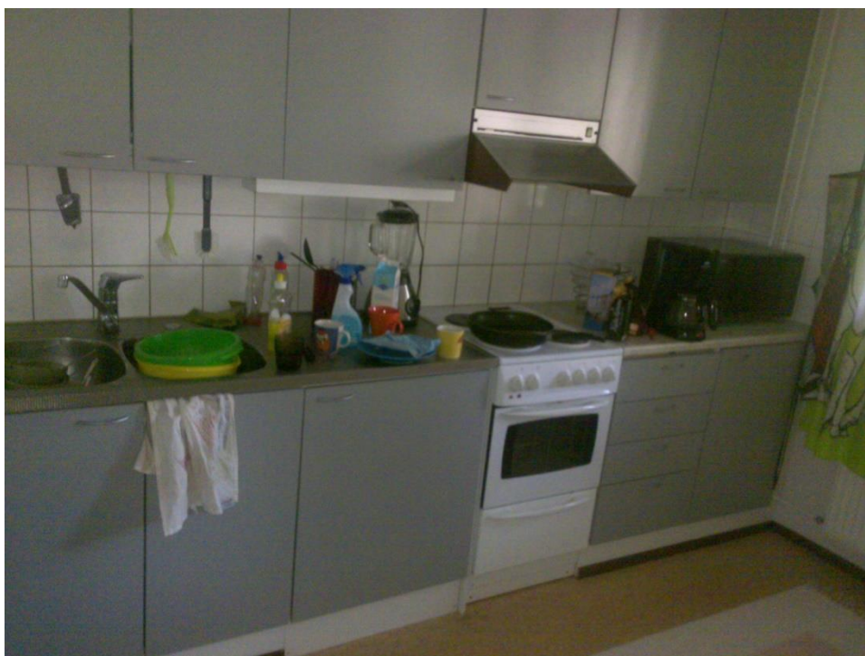
KUVA 5. Kuva korjaustarpeessa olevasta keittiöstä (Hämäläinen 2012-06-07)
