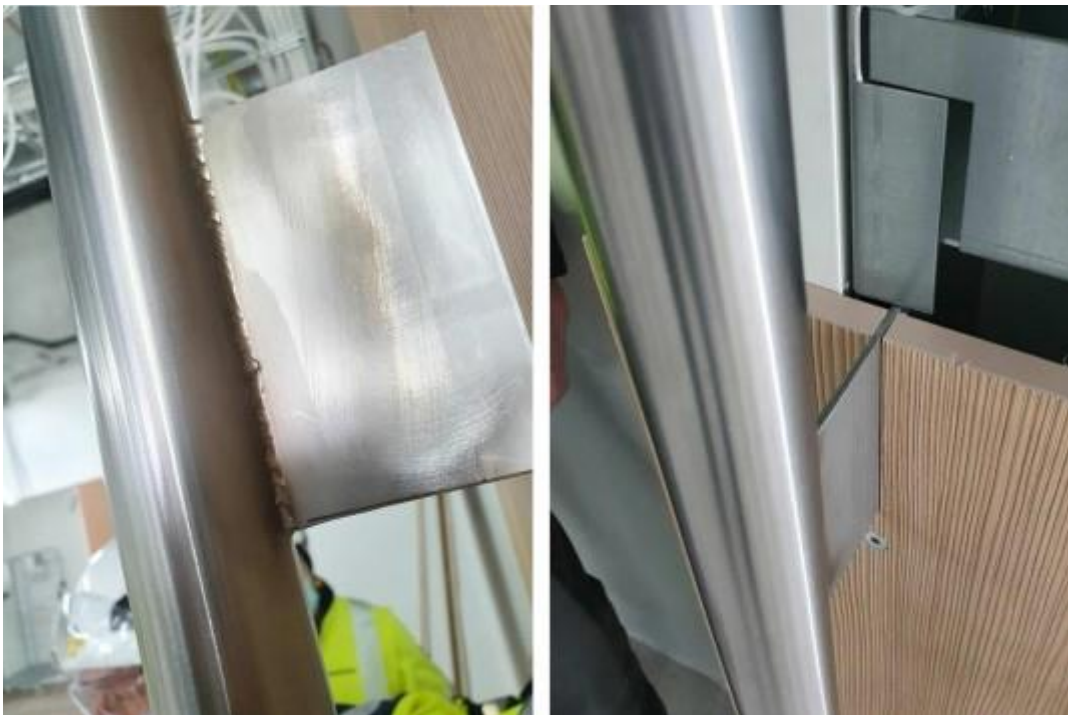
KUVA 16. Vääränlainen teräsputken ja paneelirungon välinen teräslevy
