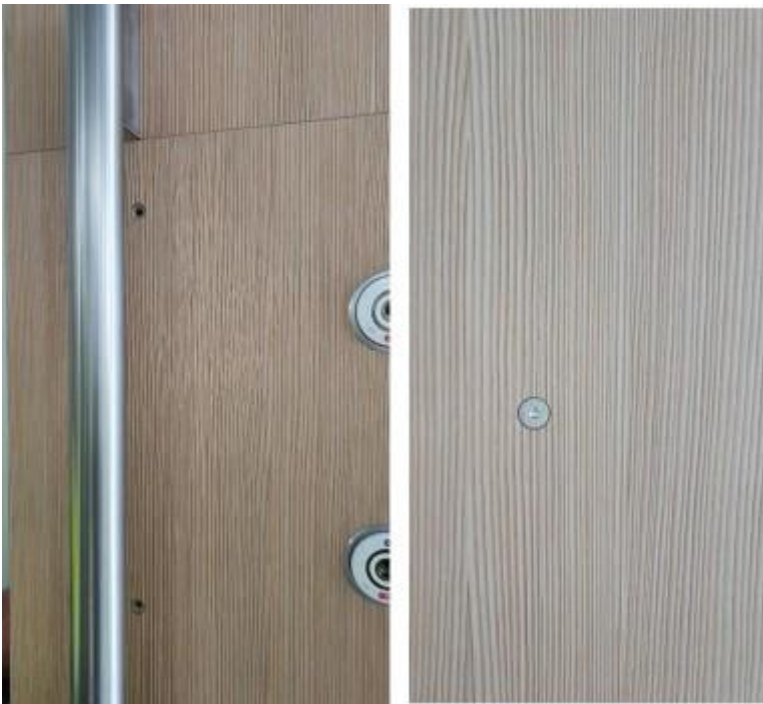
KUVA 18. Etulevyn vasemmanpuoleiset kiinnitykset hankalassa paikassa teräsputken takana
