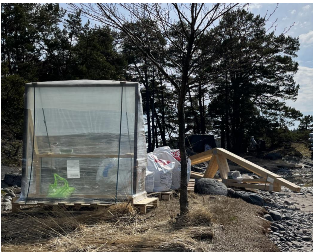
Kuva 8. Proomun nosturilla tarvikkeet ja materiaalit on saatu nostettua riittävän turvalliseen ja tasaiseen paikkaan.
