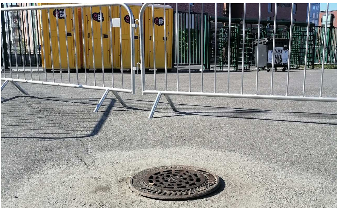
Kuva 94. Sadevesikaivo luo kompastumisriskin sisäänkäyntialueella.
