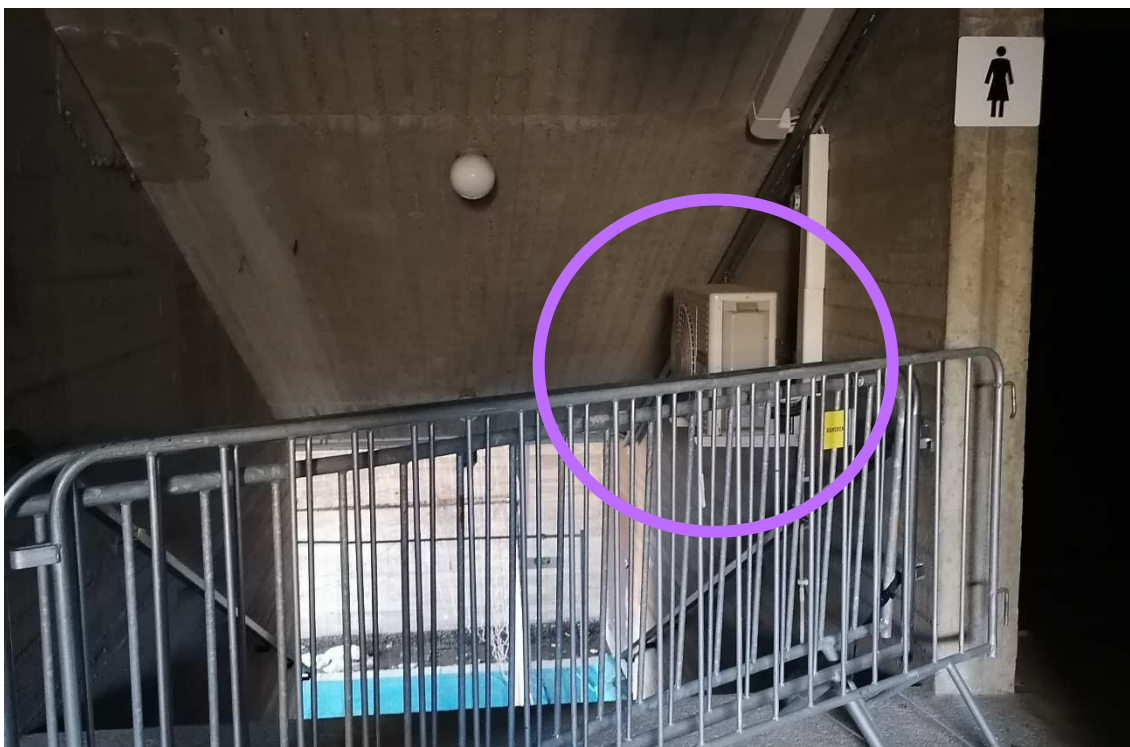
Kuva 88. WC-käytävän kautta on yhteys kentälle. Kuvassa oikealla on IV-koneen ulkoyksikkö, joka aiheuttaa törmäysriskin. Tilaisuuksien ulkopuolella portaiden käyttö on estetty siirrettävillä aidoilla.
