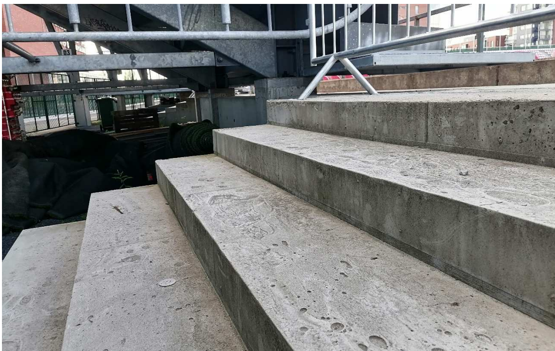
Kuva 99. Askelmien betonipinnassa on epätasaisuuksia.
