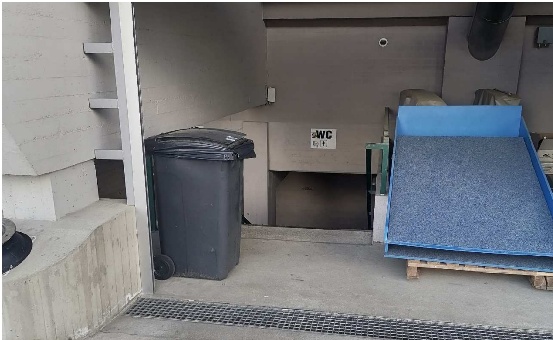
Kuva 24. Kulkuyhteyksillä on törmäysvaara säilytettävän kaluston vuoksi.
