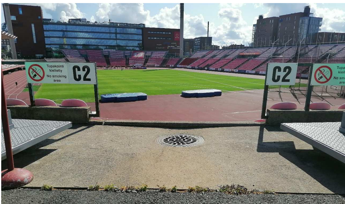
Kuva 79. C-katsomon alaosaan johtavan portaan edessä on suuri kompastumisvaara.
