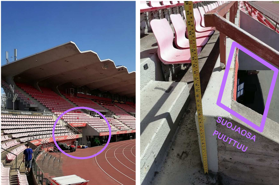
Kuva 38. Porttikäytävän yläpuolella puuttuva suojaosa luo putoamisriskin.
