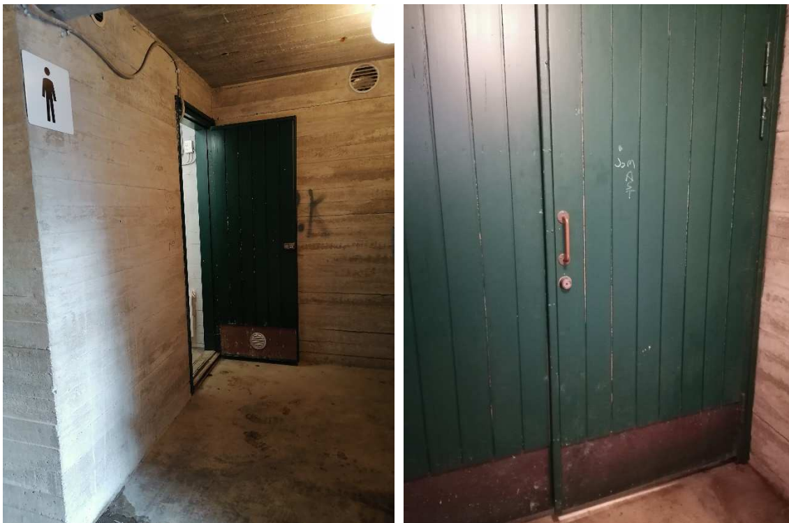
Kuva 89. WC-tilojen opasteet ovat harhaanjohtavat. Vasemmassa kuvassa näkyy opastetta lähinnä oleva siivouskomeron ovi. Oikeassa kuvassa on WC-tilan pariovi, jossa ei ole opastetta.
