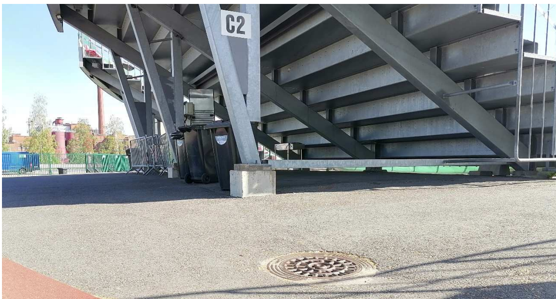
Kuva 77. C-katsomon ylärivien alle muodostuu näkövammaiselle kulkureitiltä ajautumisen ja katsomorakenteisiin törmäämisen vaaran. Alusta tulee aidata. Sadevesikaivojen kannet ovat samassa tasossa pinnan kanssa.
