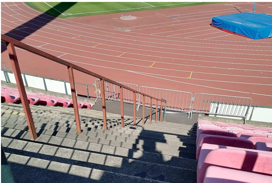
Kuva 111. Stadionin päätykatsomoissa on muutamia leveiden portaiden keskelle asennettuja kaiteita. Kiinteisiin kaiteisiin tulee lisätä kunnolliset käsijohteet.
