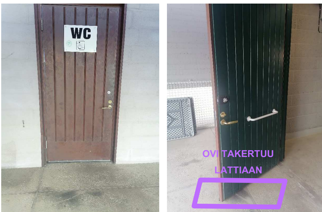
Kuva 47. LE-symboli näkyy heikosti. Ovi takertuu auetessaan betonilaattaan.
