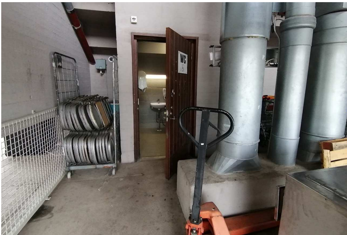
Kuva 50. A4-lohkon LE-WC:n kulkureitti on tukittu betonirakenteella. Ovi ei aukea kokonaan.
