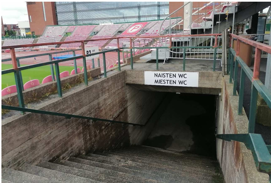
Kuva 87. Käytävä WC-tiloihin on pimeä, portaista puuttuvat tummuuskontrastit ja varoitusalueet sekä avokaiteet aiheuttavat putoamisvaaran.
