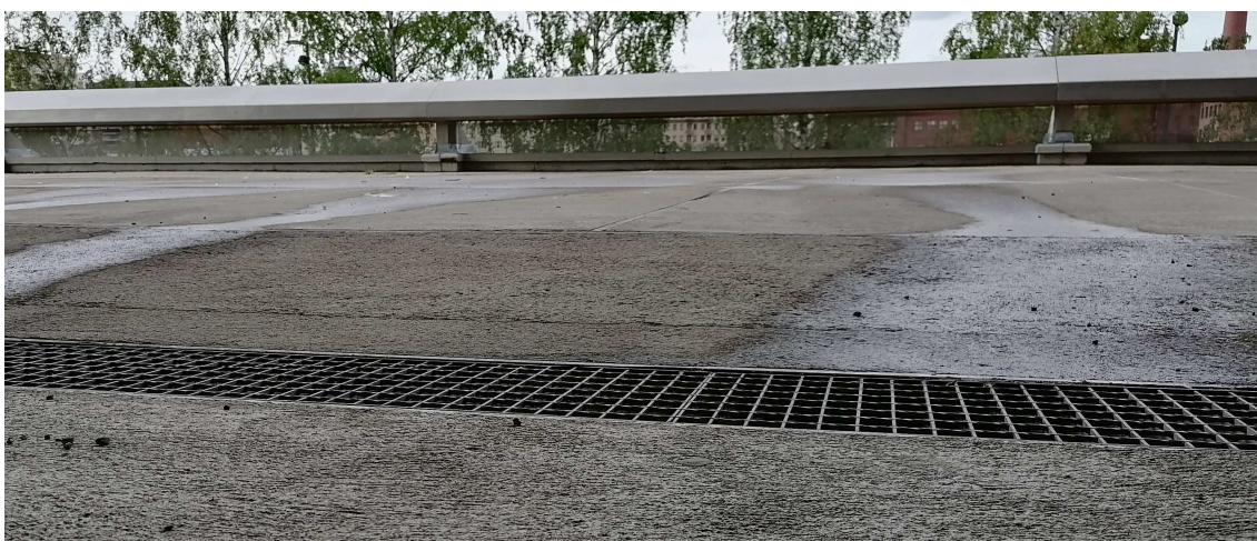
Kuva 80. Pyöreä sadevesikaivo tulee korvata ritiläkourulla, jotta saadaan poistettua alaspäin laskeutuvien portaiden edessä oleva kompastumisvaara.
