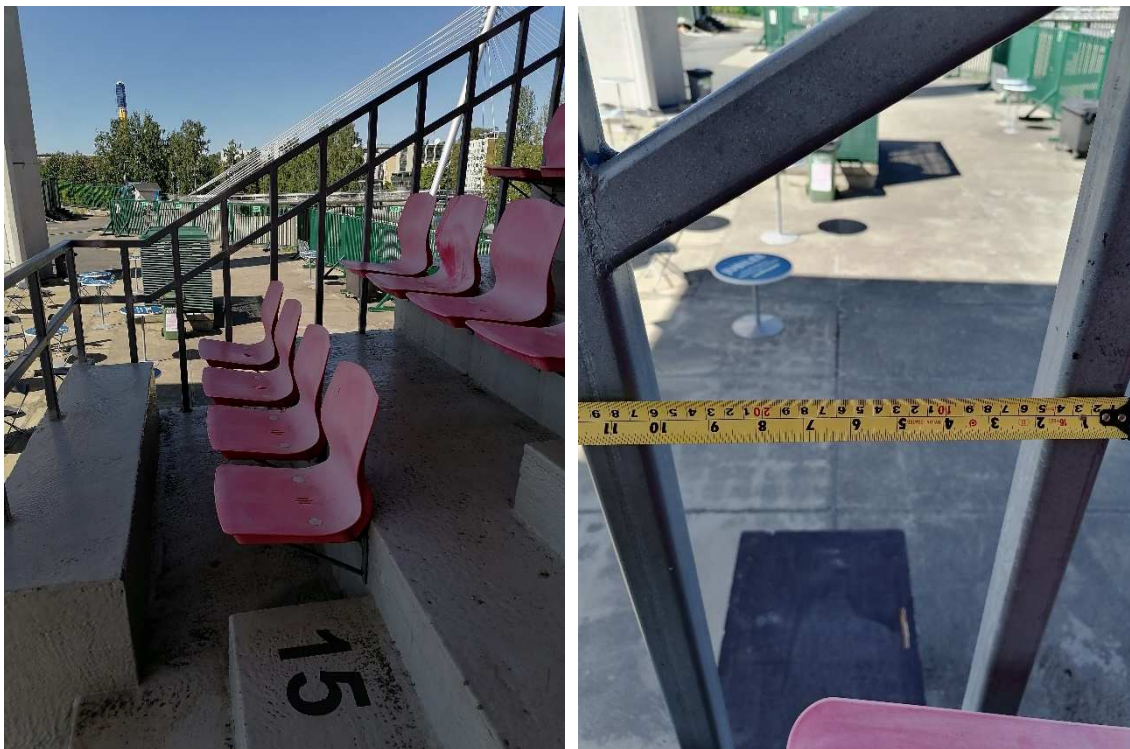
Kuva 33. Ennen korjausta sivukaide ei ehkäissyt putoamista. Määräysten mukaan aukko saa olla maksimissaan 100x100 mm.
