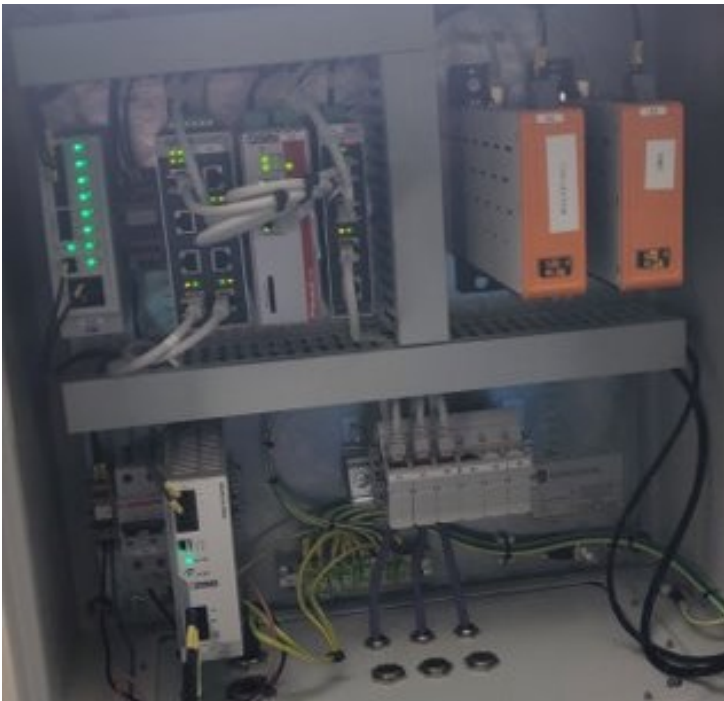
Kuva 22. Kuva asennetun Light Monitoring -järjestelmän DLU-paneelin sisältä
