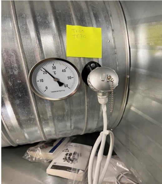
Kuva 3. Asennettu kanavalämpötila-anturi ja paikallismittari.
