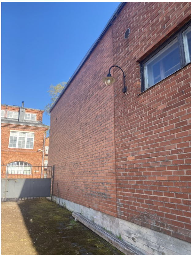
KUVA 32. Pohjoisjulkisivussa on orgaanista kasvustoa (Jori Leppinen 2023).
