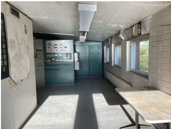
KUVA 39. Näkymä toisen kerroksen valvomossa. Kuvan sähkölaitteet ovat poissa käytöstä (Jori Leppinen 2023).
