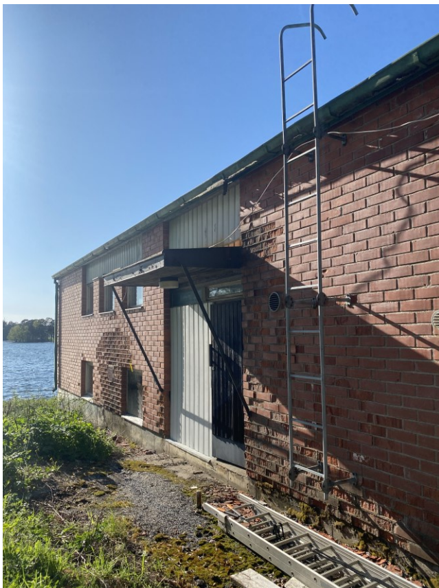
KUVA 31. Vesilaitoksen eteläjulkisivussa on rapautumisvaurioita ja sadevesikouruissa on reikiä (Jori Leppinen 2023).
