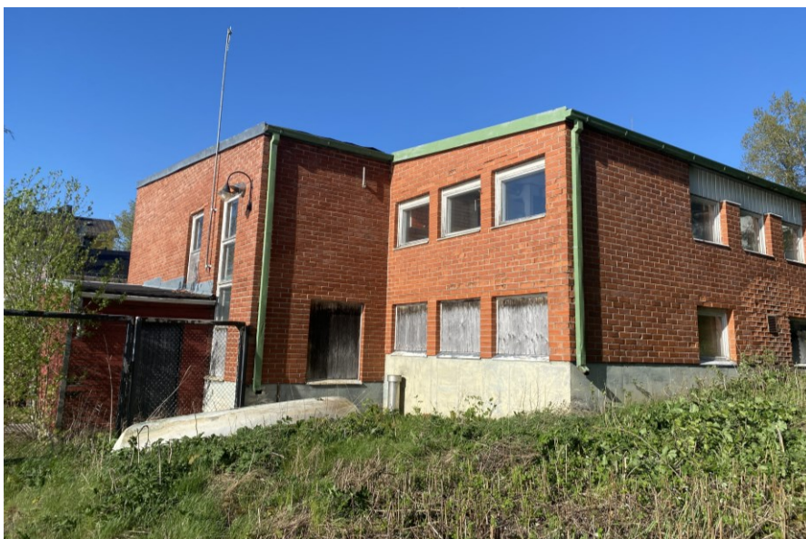
KUVA 33. Rakennuksen ikkunoita on peitetty vanerilla. Karmeissa on lahovaurioita (Jori Leppinen 2023).
