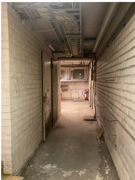
KUVA 40. Ensimmäisen kerroksen laajennusosan käytävän lattiasta on lohkeillut paloja ja väliovissa on homekasvustoa sekä likaa (Jori Leppinen 2023).
