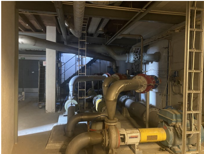
KUVA 37. Näkymä ensimmäisen kerroksen pumppuhuoneeseen (Jori Leppinen 2023).
