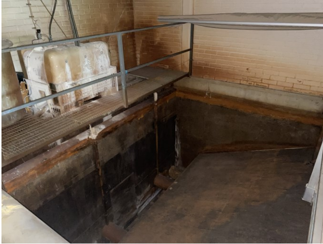
KUVA 42. Selkeytsaltaan seinämissä ja laiteissa on ruostetta ja likaa, jota on roiskunut myös seinille (Jori Leppinen 2023).
