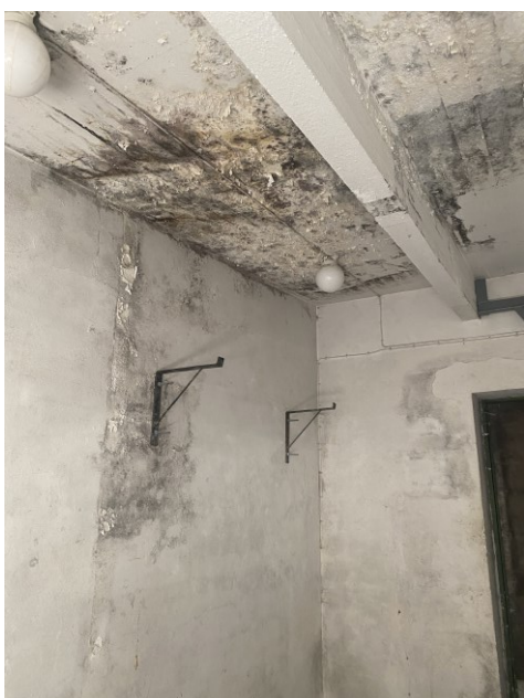
KUVA 41. Kemikaalivaraston katto- ja seinäpinnoilla on hometta ja niistä lohkeilee maalia (Jori Leppinen 2023).
