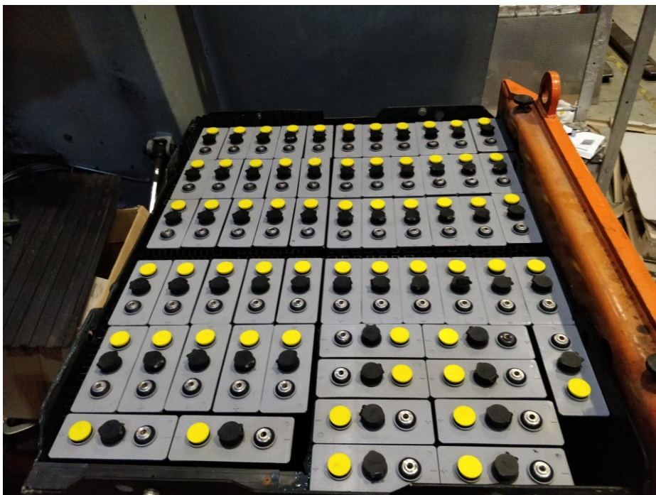
Kuva 6. Uudet akkukennot nostettuna kunnostettuun paikallaan olevaan akkukoteloon.
