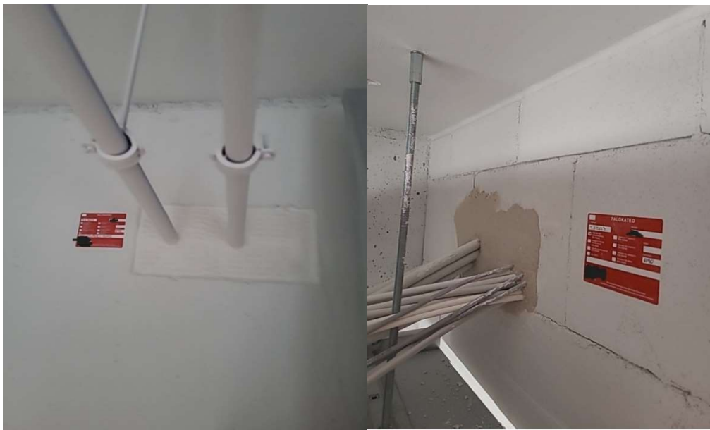
Kuva 3. Vasemmanpuoleisessa valokuvassa palokatko toteutettu pinnoitetulla palokatkolevyllä ja akrylipohjaisella palokatkomassalla. Oikeanpuoleisessa valokuvassa palokatko toteutettu kipsipohjaisella palokatkomassalla. Valokuvat Helsingissä sijaitsevalta työmaalta.
