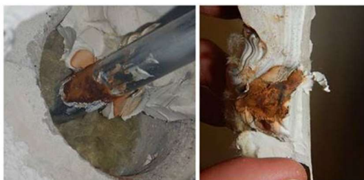
Kuva 6. Palokatkomassan kohdalla ruostetta.
