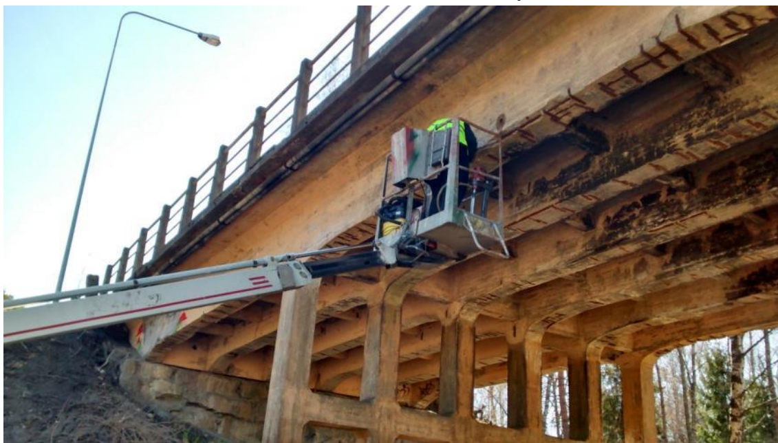
KUVA 37. Yleisnäkymä haoista. Kuvassa näkee myös alapinnan raudoituksen reunimaisten tankojen olevan ilman betonipeitettä.
