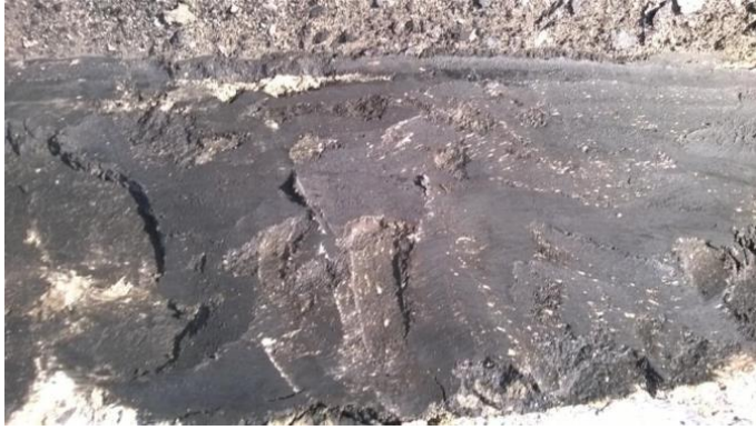
KUVA 43: Mastiksimaista vedeneristettä kansirakenteessa
