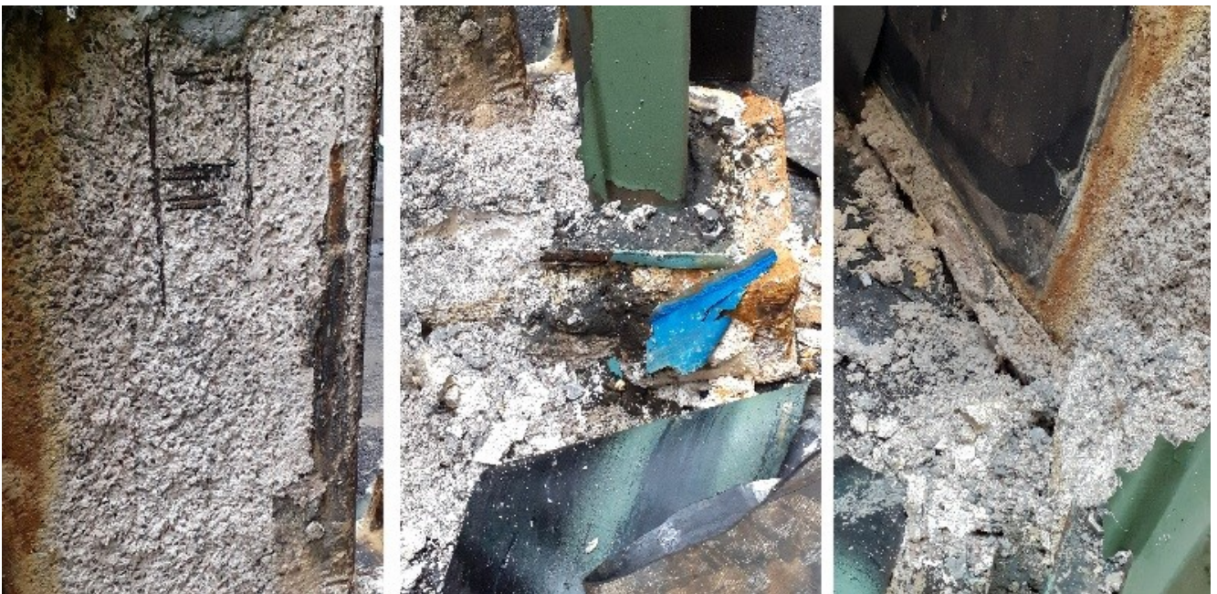
Kuva 2. Hapon aiheuttama betonivaurio
