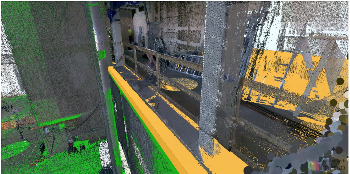
KUVA 13. Laatan korkopoikkeama havaittu automaattisella poikkeamien tunnistuksella.
