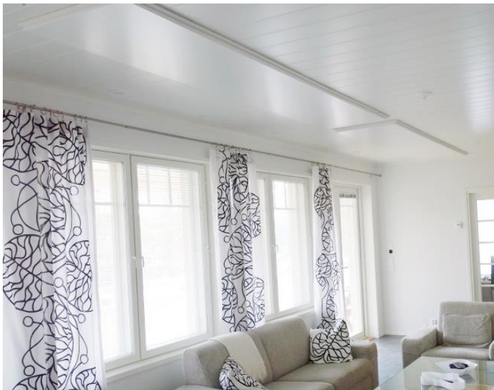
Kuva 9. Lämmitys- ja jäähdytyskäyttöön sopivat kattosäteilijät asunnossa [23].
