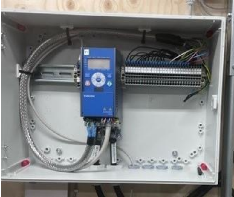
Kuva 16. Taajuusmuuttajan pysyvät johdotukset
