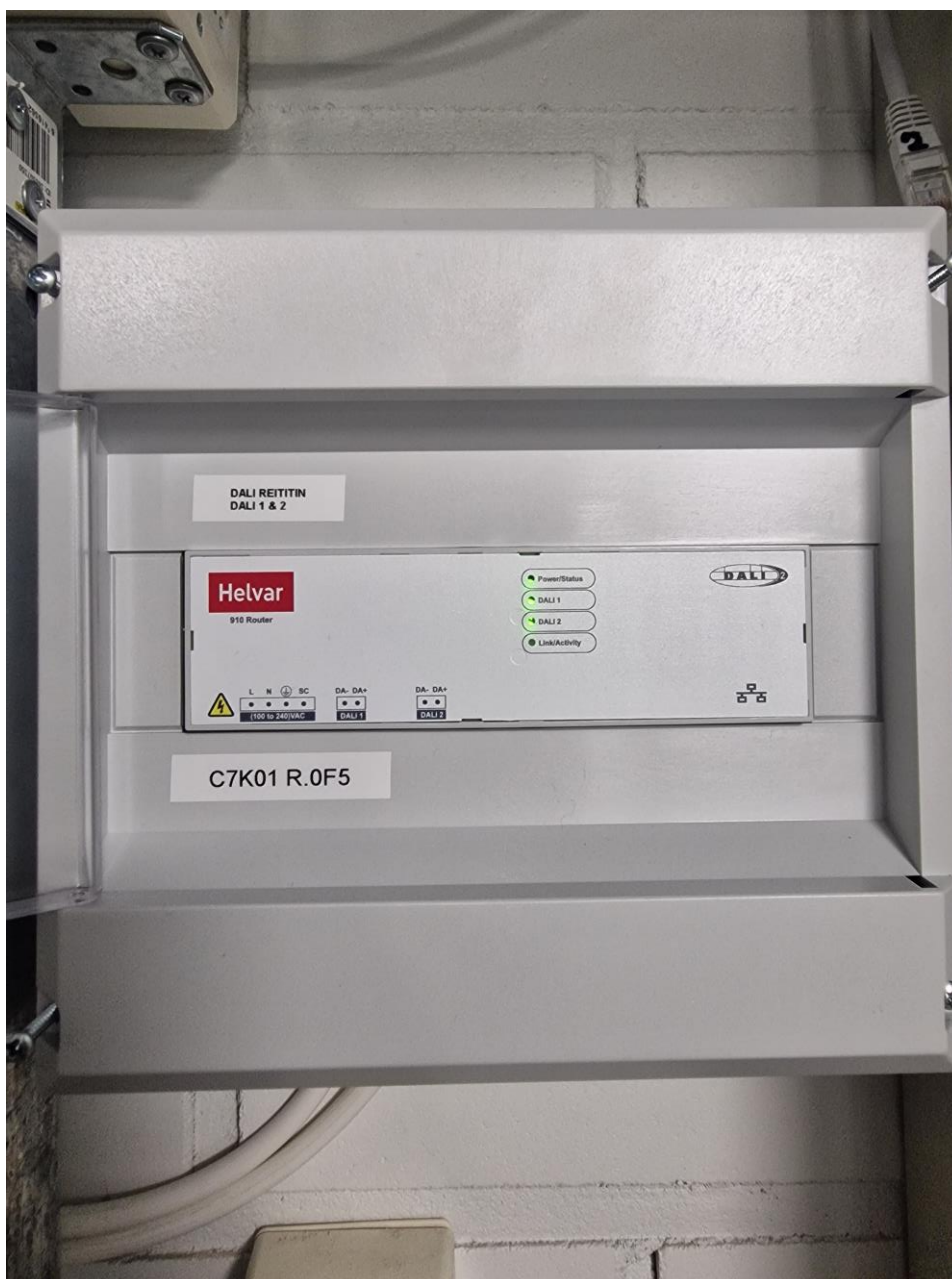
Kuva 4. Kaksikanavainen Dali-reititin asennettuna pintakoteloon.
