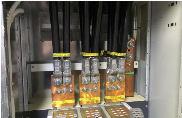
Kuva 13. Näkyvänvalon kuva pääkatkaisijan syöttöpuolelta
