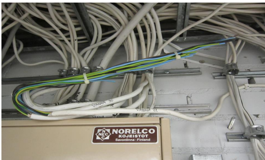
Kuva 6. Keskustilassa päättelemättömiä MMJ-kaapeleita
