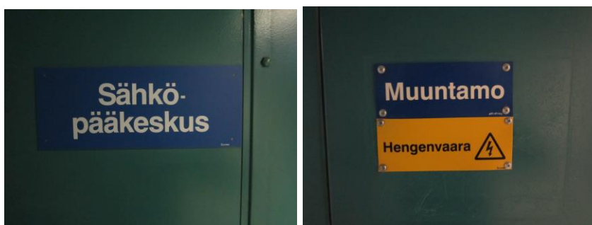
Kuva 18. Sähköpääkeskus- ja muuntamo-ovikyltit
