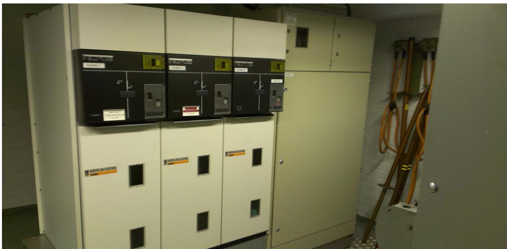
Kuva 2. Merlin Gerin kennoja kytkintilassa
