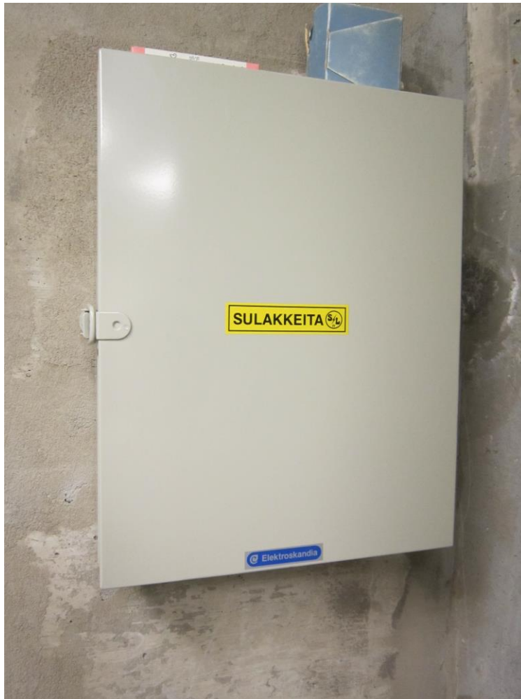
Kuva 16. Iso sulakekotelo varasulakkeiden säilytystä varten
