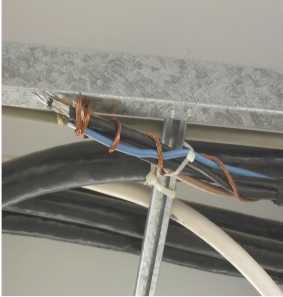
Kuva 7. Kaapelihyllyssä, keskustilassa päättelemätön AXMK-kaapeli
