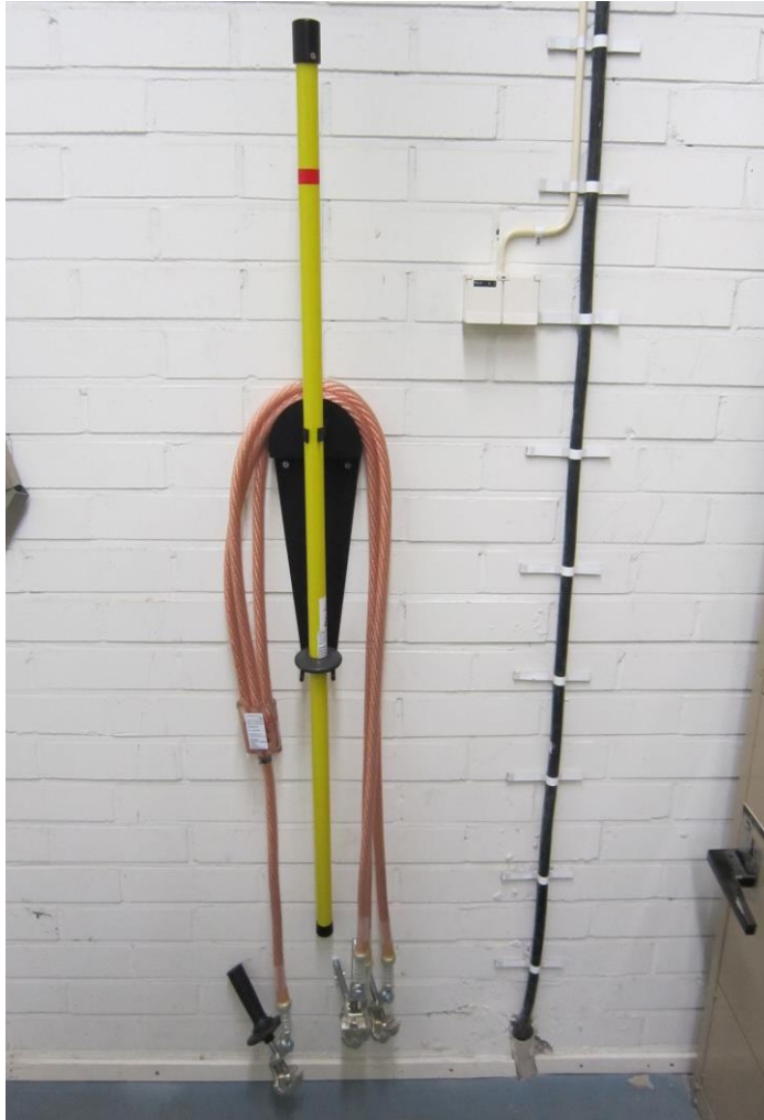
Kuva 19. Maadoituskaahleet ja -sauva
