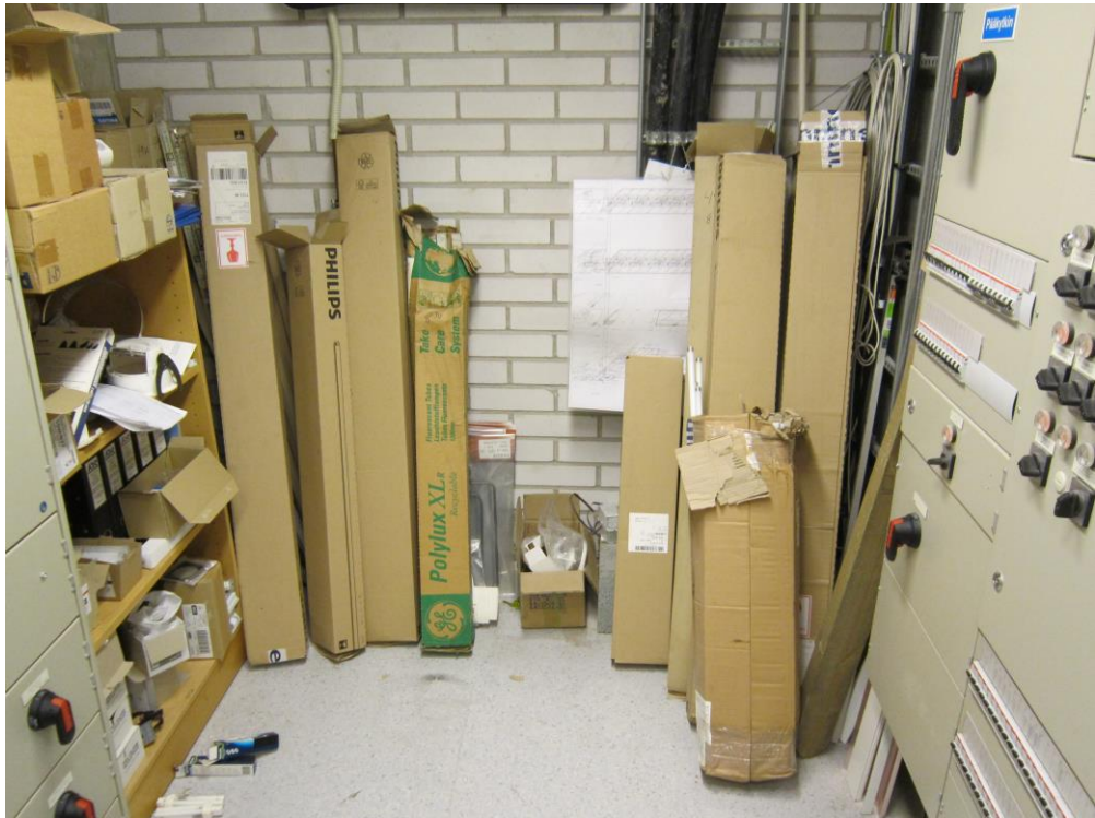
Kuva 4. Sähkökeskustilassa ylimääräistä palokuormaa
