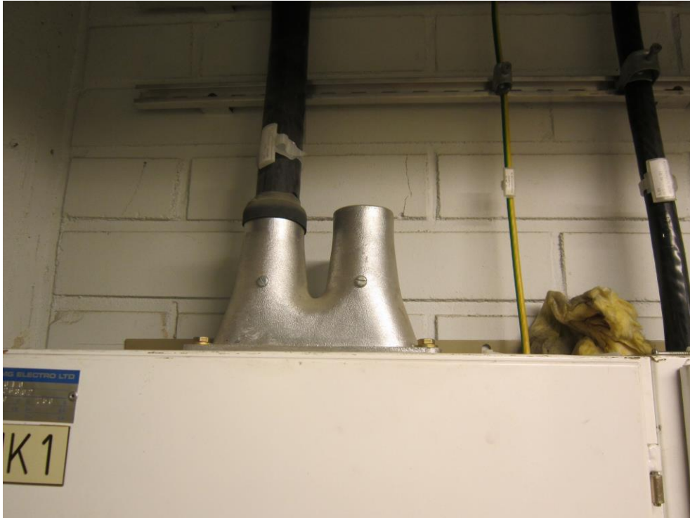
Kuva 9. Keskuksessa tukkimaton kaapeliläpivienti
