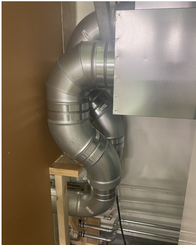
Kuva 16. Kanaviston mutkittelua tilanpuutteen vuoksi.
