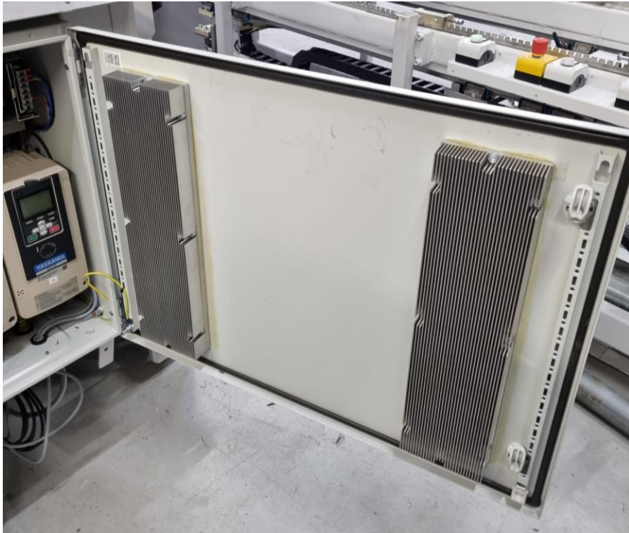
KUVA 50. Sahakoneen pääkeskuksen jäähdytysrivat.
