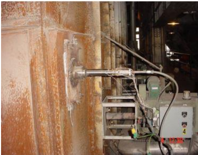
Kuva 11.5 Korroosiosondi testilaitoksessa (Heng 2006).
