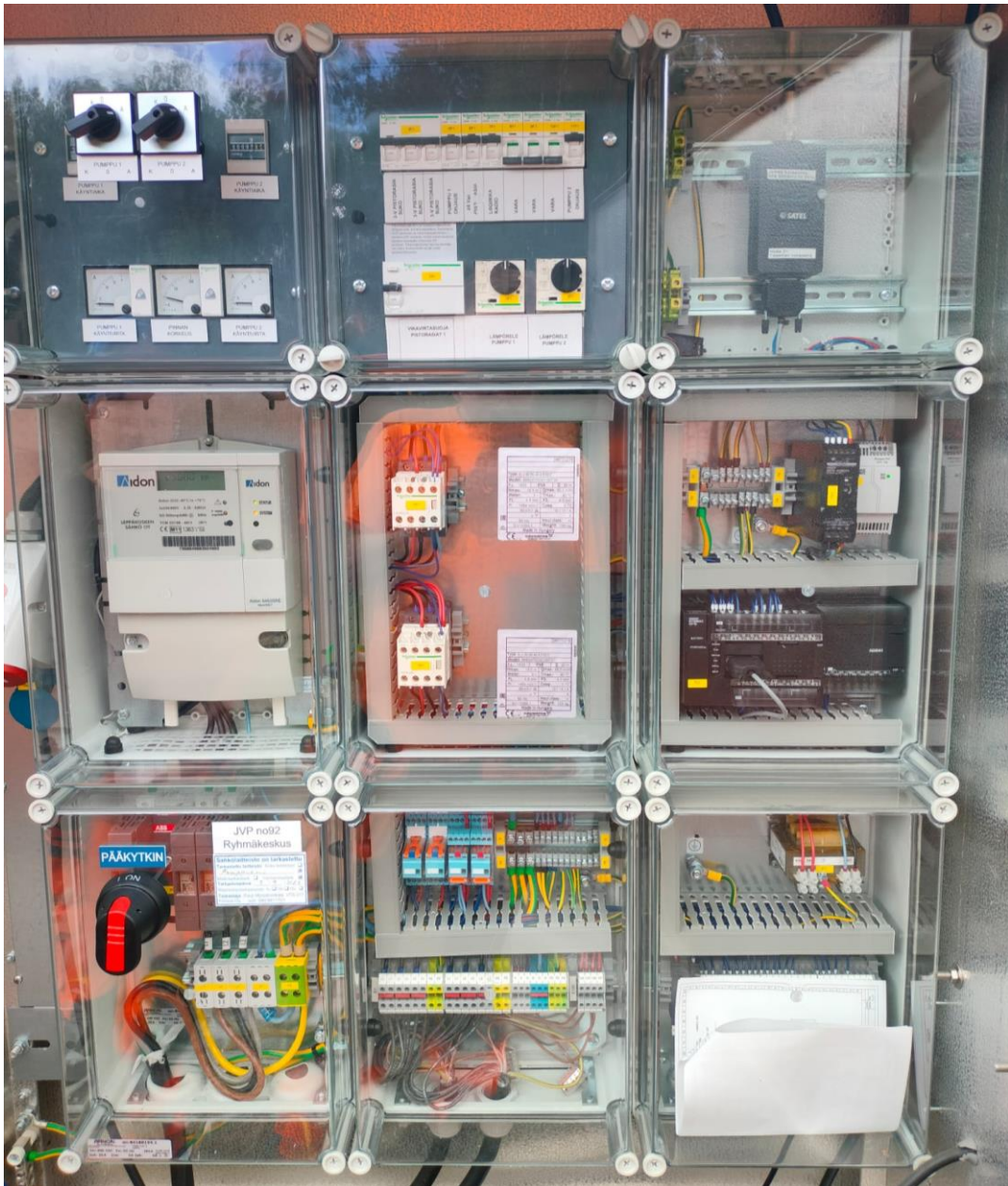
KUVA 12. Jätevesipumppaamon sähkökaappi (Hepola 2023)
