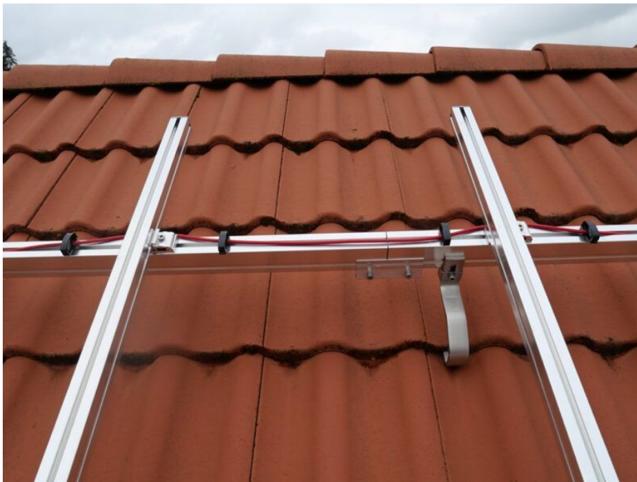
Kuva 3. Kiinnitystelineeseen Schletter-tuotemerkin UV-säteilyä kestäväillä kiinnikkeillä kiinnitetty DC-kaapeli [23].
