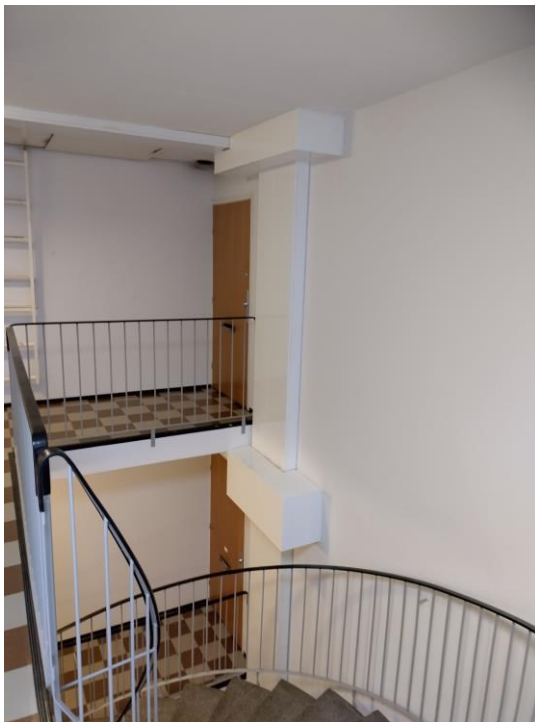
Kuva 10. Taloyhtiön rappukäytävän kaapelikanavat.
