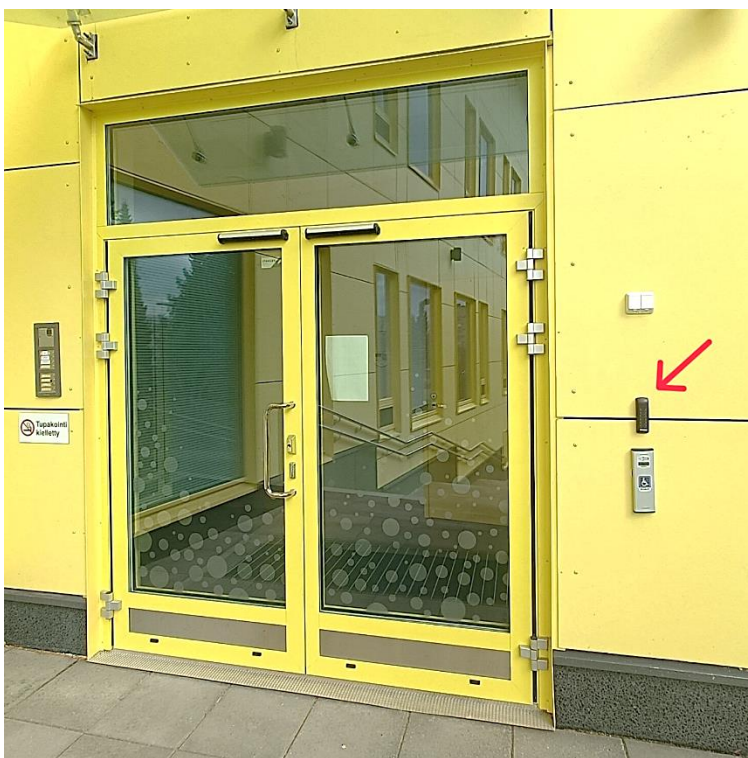
Kuva 12: Kulunvalvonnalla suojattu ulko-ovi. Kuvassa Tampereen Kalevassa sijaitsevan Pellervon päiväkodin sisäänkäynti. Kulunvalvonnan lukija on merkitty kuvaan punaisella nuolella. (Kuva: Pönnighaus, 2023)
