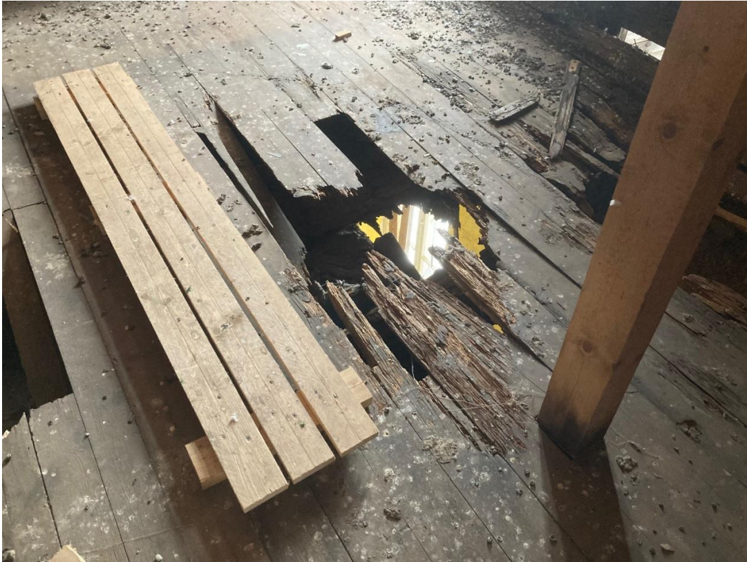
KUVA 6. Välipohjassa olevia reikiä sisääntulotilan kohdalla.
