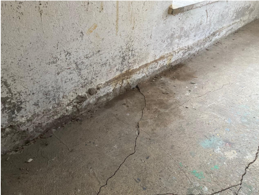
Kuva 5. Alapohjarakenteen halkeamia ja rakoja
