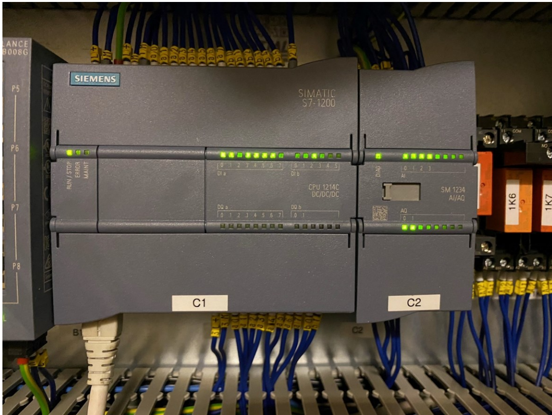
KUVA 10. Siemens S7-1214 PLC ja analogiamoduuli kytkettynä
