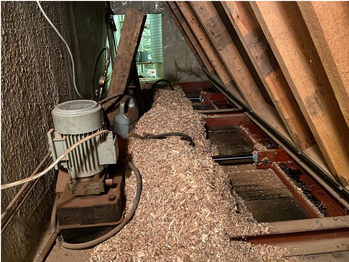
KUVA 14. Hydraulipumppu ja työntökolat
