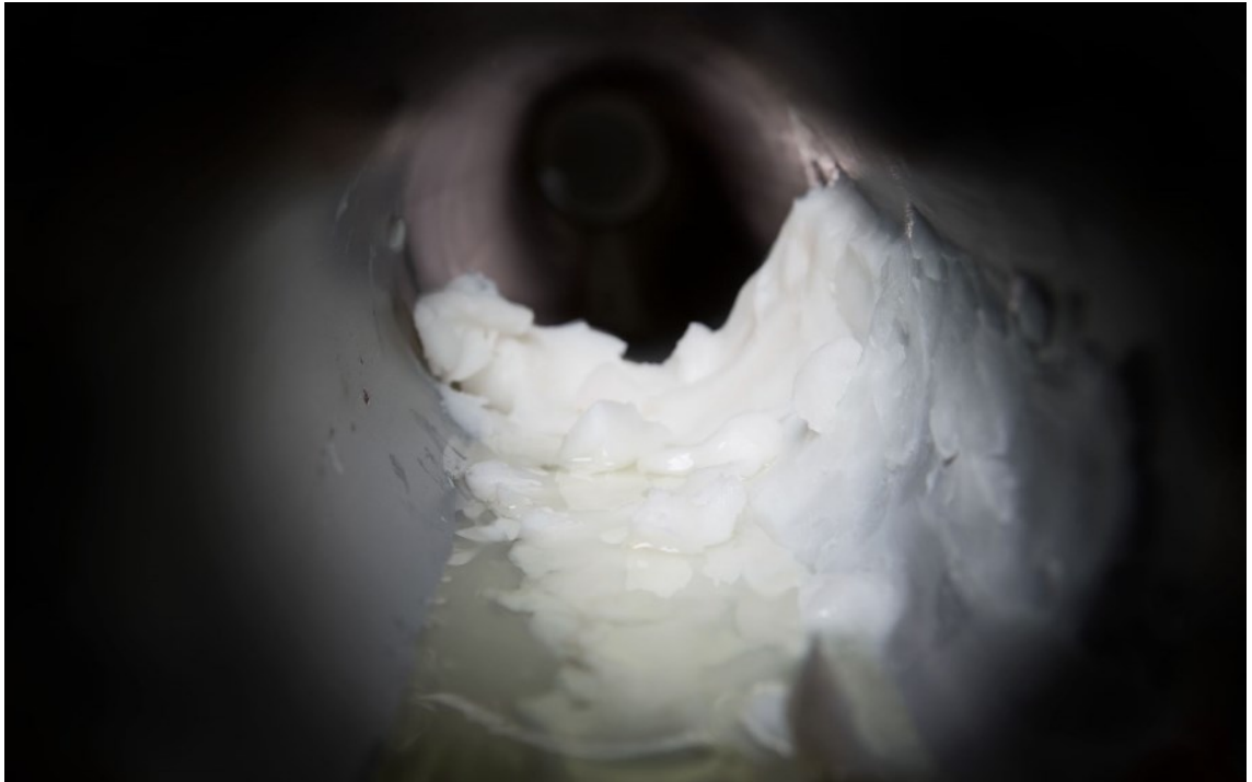
Kuva 4. Rasvajäte viemäriputkessa (Helsingin seudun ympäristöpalvelut).
