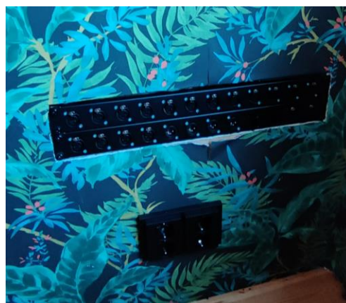
6.0.3 Bild: Inspelningsrum, kopplingstavla A
