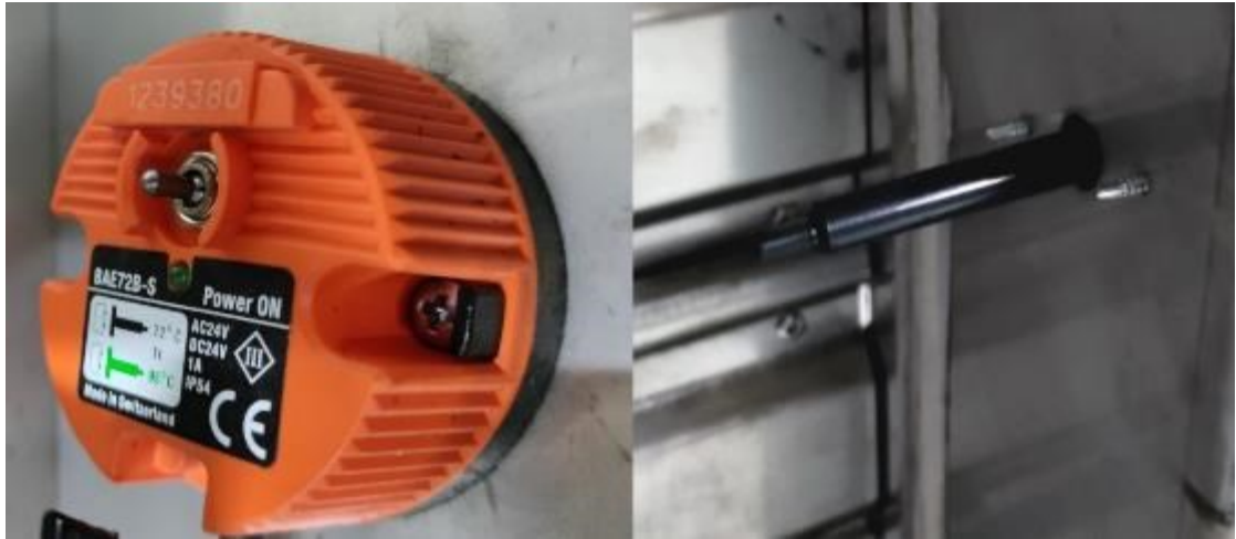
Kuva 2. Palopellin runkoon kiinnitetty BELIMO BAE72B-S lämpötilakytkin (Hammarén 2022.)
