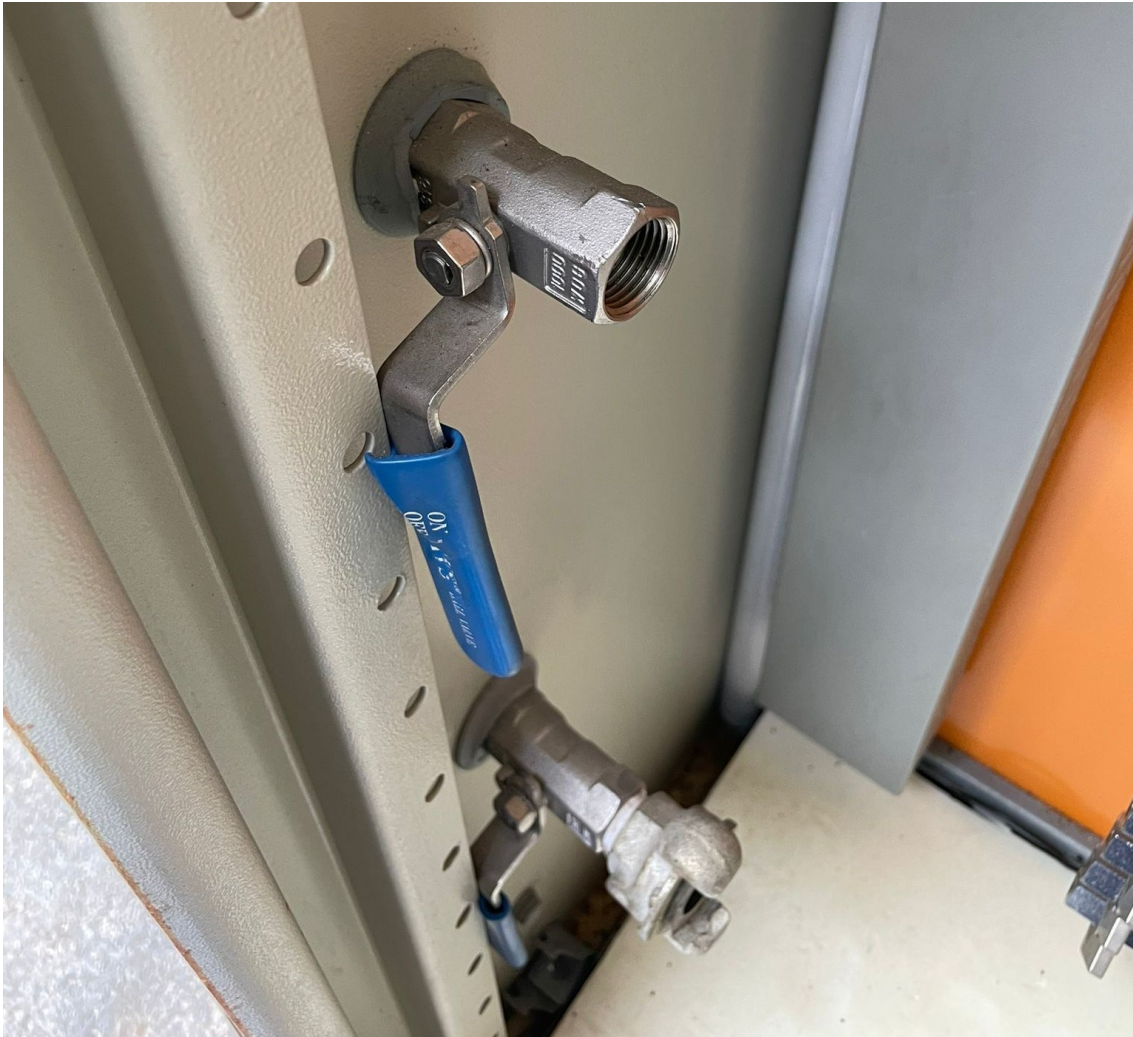
KUVA 18. Auki jäänyt käsiventtiili
