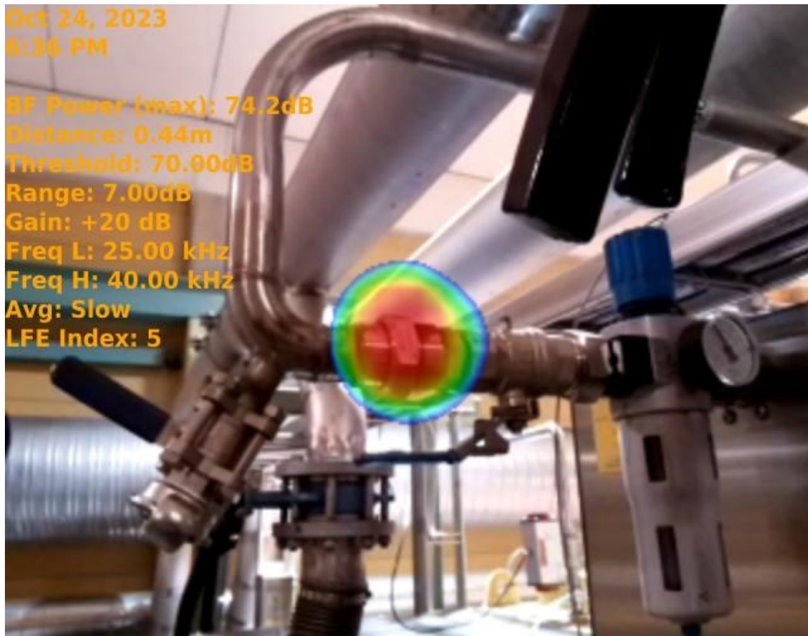
KUVA 19. Kameran havaitsema vuoto paineilmalinjan liitoksessa
