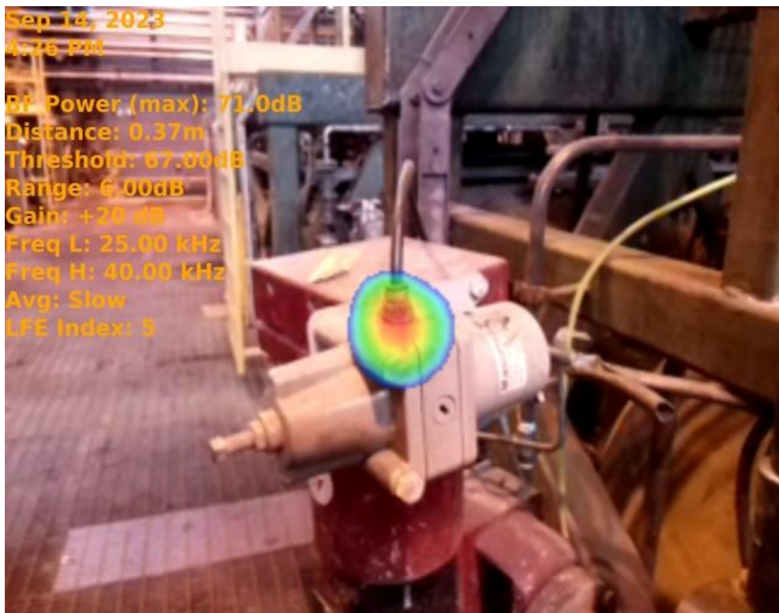
KUVA 12. Kameralla otettu kuva instrumentointiletkun liitos vuodosta
