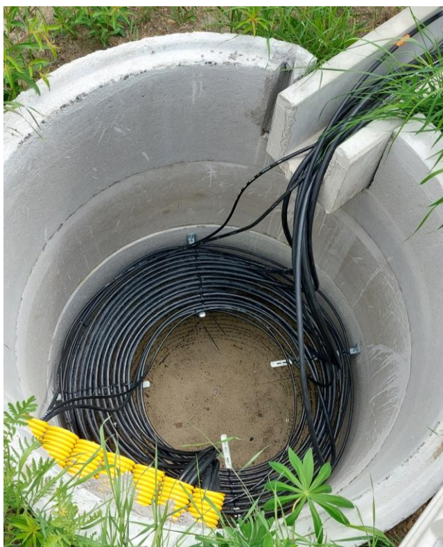
Kuva 1. Kaapelikaivo tien alituksen kohdalla
