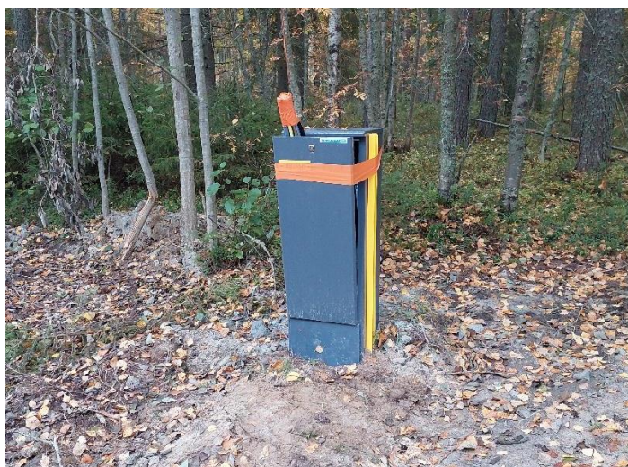
Kuva 1. Kaapelinpäät sekä jakokaappi on suljettu teipillä ja maanpinta viettää poispäin (Kuva: Kalle Keränen).
