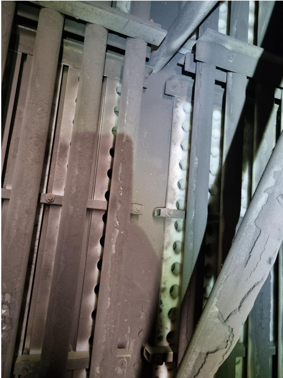
Kuvio 11. Suodatinelementeissä vuotoja ja pölyä. (Industri-Textil Job Oy 2023.)
