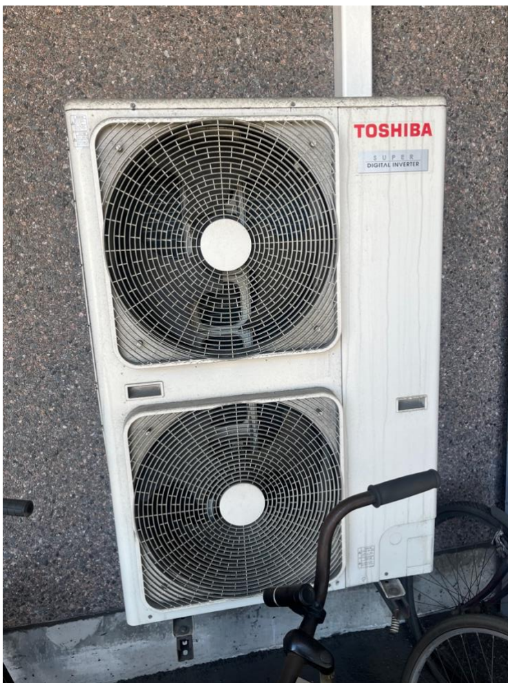
Kuva 6 Suurteollisuuspuistossa sijaitseva ilmajäähdytteinen ulkoyksikkö. (Elo, 2023)
