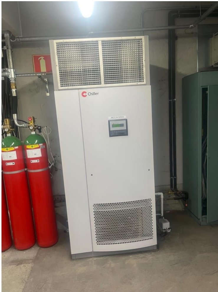
Kuva 2 Chillerin kaappijäähdytyskone. (Elo, 2023)
