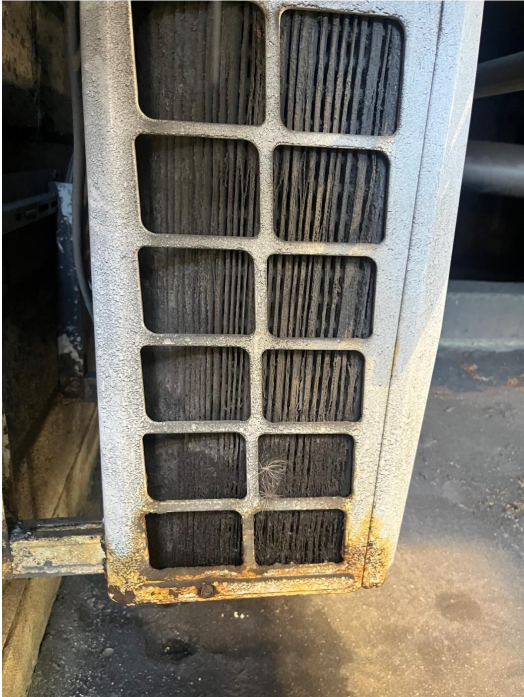
Kuva 11 Olosuhteista kärsinyt ulkoilmayksikkö. (Elo, 2023)
