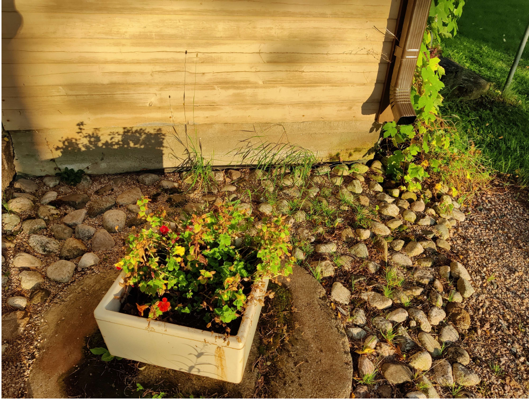
Kuva 10. Puuttuvan sadevesikaivon paikka
