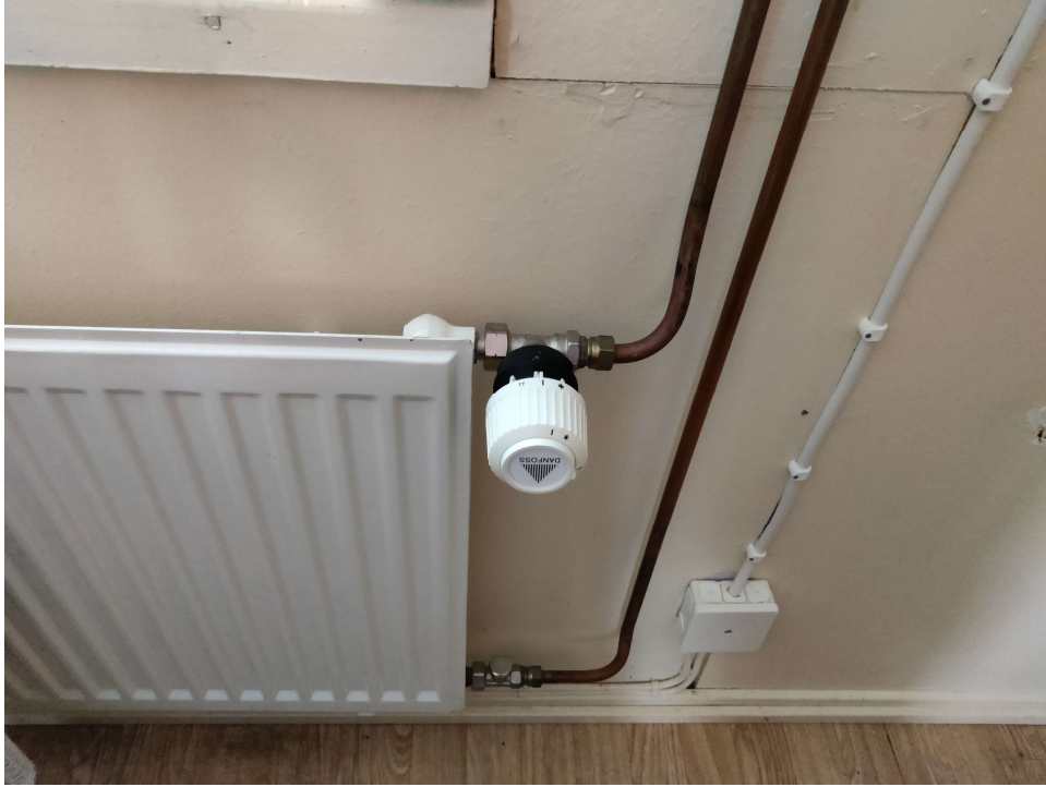
Kuva 14. Pinta-asenteisia putkia ja johtoja
