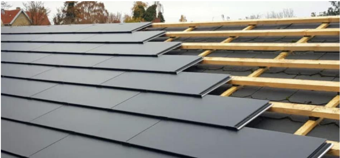
Figur 7. Solartags solcellsmoduler monterade utanpå befintligt filttak. (solartag.eu 2023).
