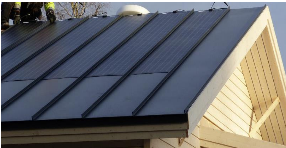
Figur 9. Virte Solar solcellsmoduler monterade på falsat plåttak. (virtesolar.fi 2023).
