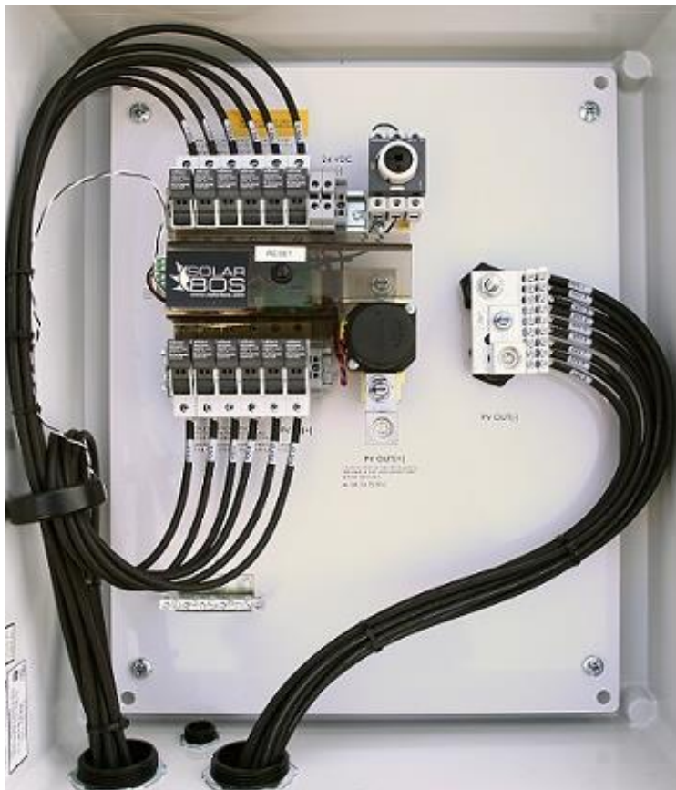
KUVA 3. Kuva combiner boxista eli yhdistelmälaatikosta (11)
