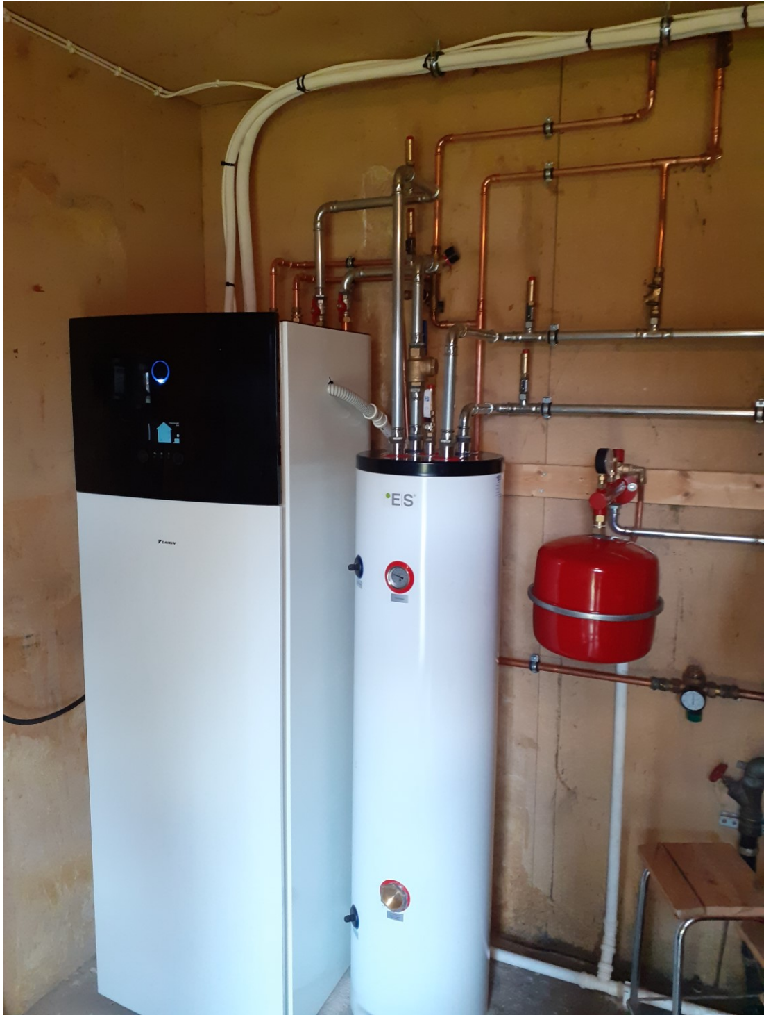
Kuva 9. Ilmavesilämpöpumpun sisäyksikkö, puskurivaraaja ja paisunta-astia. (Porola, M. 2021)
