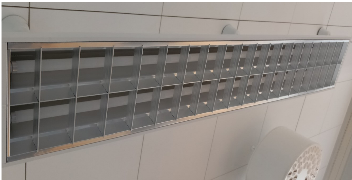
Kuva 34. Koulurakennuksen valaisin valaistussaneerauksen jälkeen. (Niskanen, 2023)
