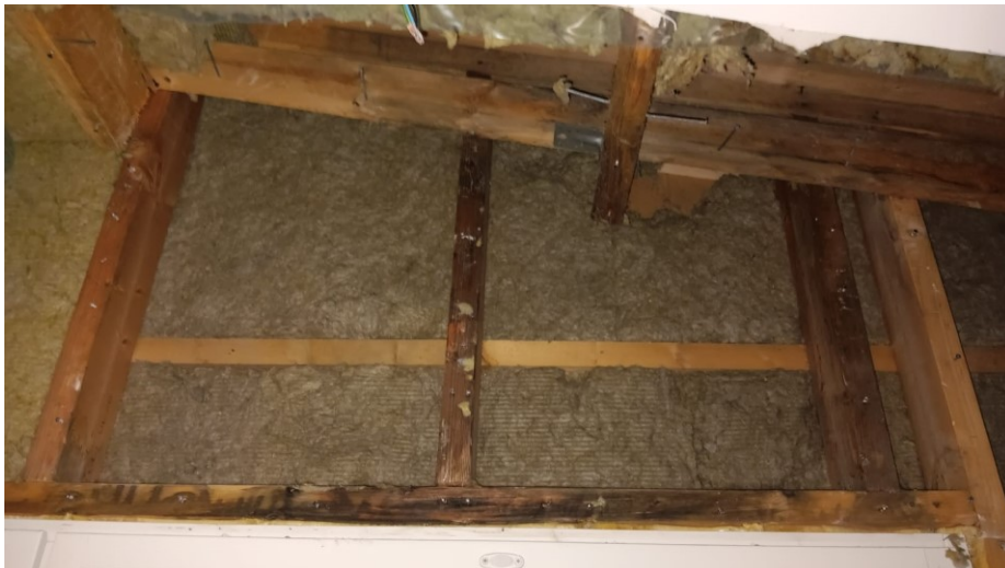
Kuva 11 Kosteusvauriot seinärakenteessa ikkunan yläpuolella
