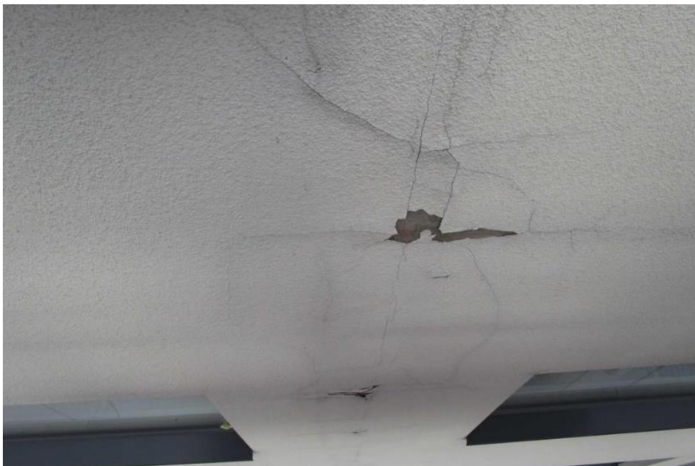
Kuva 16. Rappauksessa esiintyviä halkeamia. (Kuva: Raksystems, 2023).
