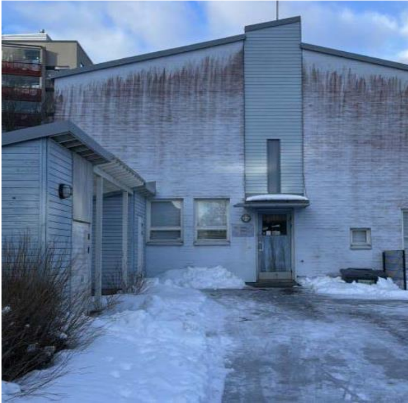
Kuva 17. Julkisivussa esiintyvää leväkasvustoa. (Kuva: Suomen Julkisivupuhdistus, 2023).
