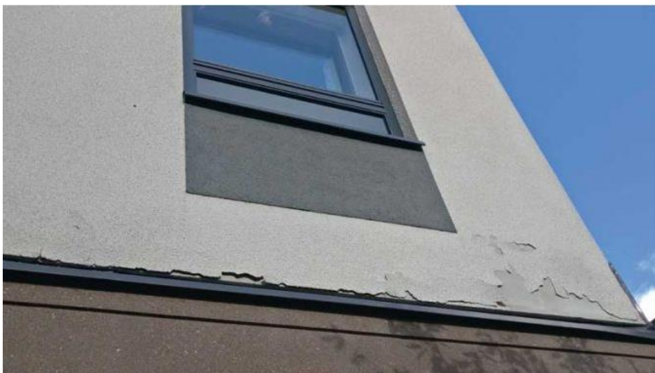
Kuva 15. Pintarappaus irronnut alustasta. (Kuva: Kiinteistöposti, Matti Eronen, Alpo Eskola, 2019).
